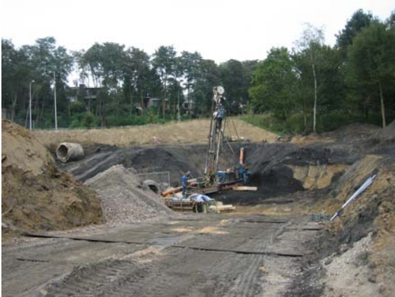
Onderzoeksboringen bij de instorting in Kerkrade (Foto: SodM)
