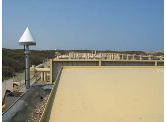
Een antenne voor een continue GPS-hoogtemeting op NAM-locatie Ameland-Oost-1. (Foto: SodM)
