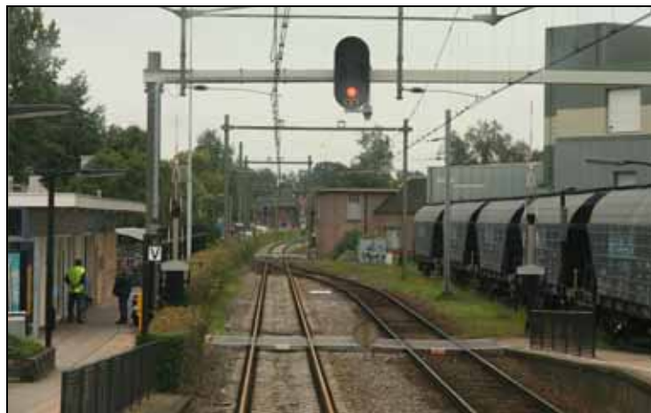
Afbeelding 12b: situatie van sein 4 op station Barneveld Centrum
