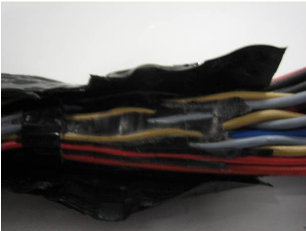
Figuur 3.4-4 Verbinding van een kabelverlenging
