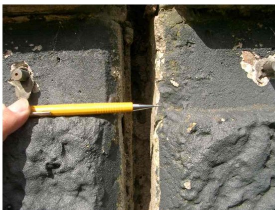
Fig 12.9.3 Openstaande voeg met meetbouten
