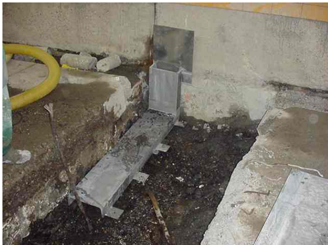
Fig 10.2.6 Voeg 4bc westbuis Om het U 300 profiel op de dilatatievoeg aan te kunnen brengen is de ballastbeton tot aan de constructievloer gesloopt. De betongoot werd droog gehouden door een vacuümpomp in een geboord gat in de voeg aan te brengen.
