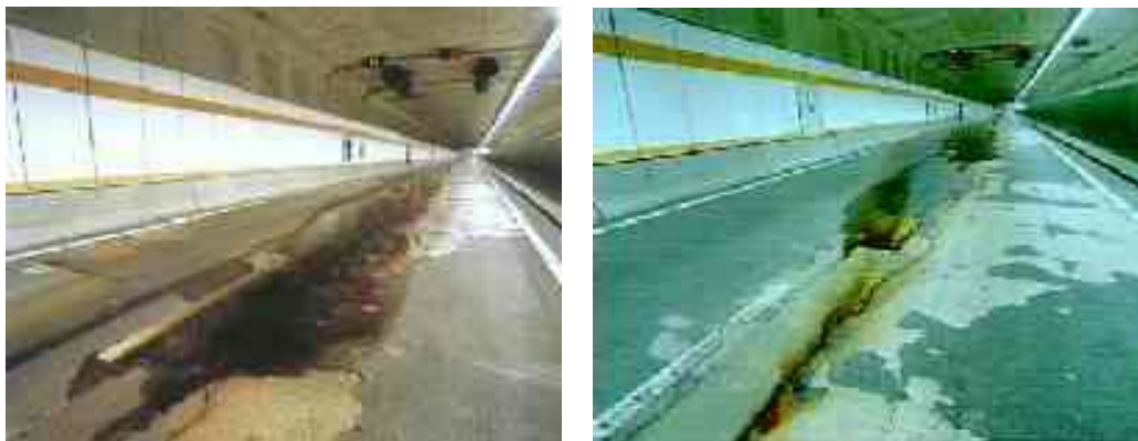
Fig 10.2.1 Lekwater met roest van de wapening op het wegdek van de westbuis
