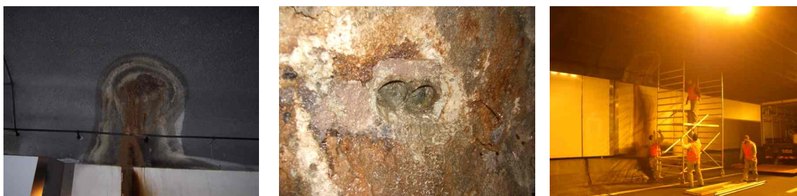
Fig 10.5.9-10-11 Lekwater tekent zich af op dak, komt uit injectiebuisen toegangschacht ibo en na injecteren met polyurethaan (Webac 1420) was de lekkage opgeheven.
