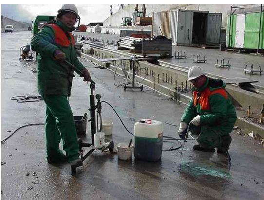
Fig 10.11.19 BAM injecteurs injecteren scheuren in de vloeren toerit met Polymert 150 mpa Het uitstromen van de injectievloeistof is duidelijk zichtbaar aan de groene kleur, de witachtige kleur duidt op reactie van water met het epoxy deel van de injectievloeistof. Deze injecteurs hebben ook de vloerinjecties op de onderdoorgang A5 Schiphol uitgevoerd.
