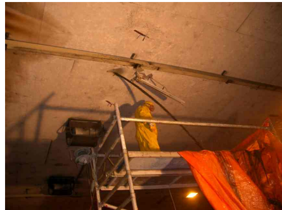
Fig 10.10.5 Zand met water spuit uit het boorgat, uit de dilatatievoeg !
