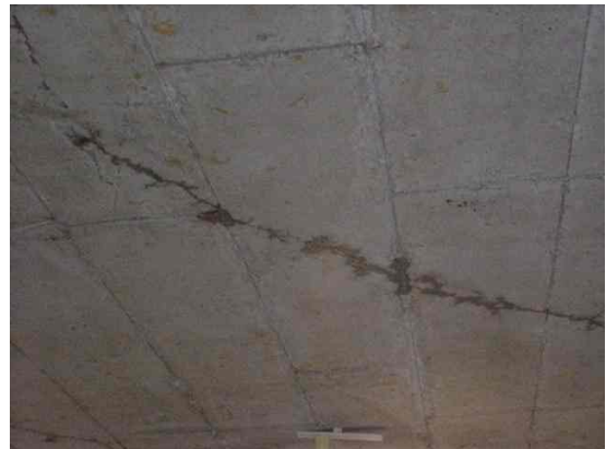
Fig 10.11.18 Doorgaande scheur in dak
