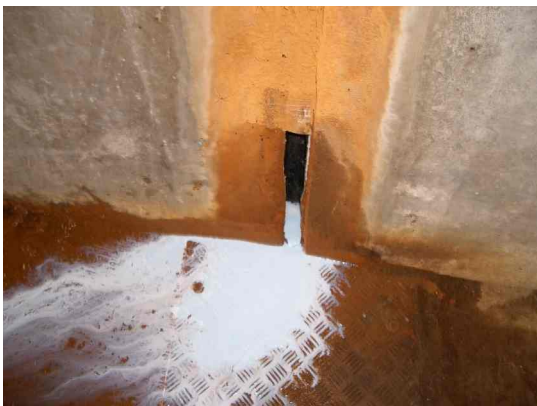
Fig 10.15.3 Latex stroomt via lekweg uit de middenvoeg
