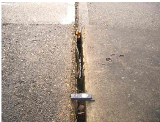
Fig 10.14.2 Openstaande en lekke dilatatievoeg
