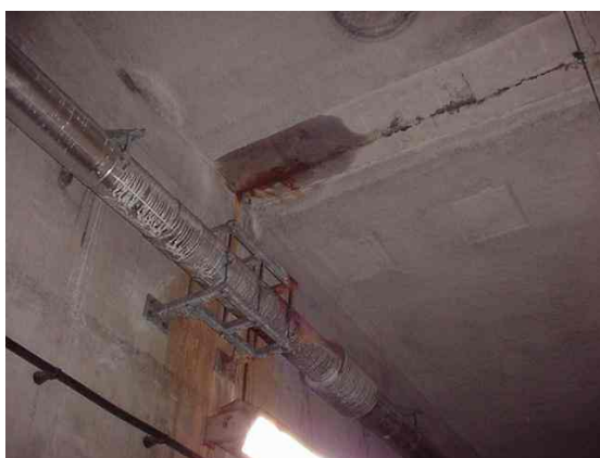
Fig 10.11.3 Lek sluitvoeg op 17-5-2004 metro bus G
