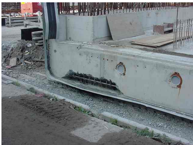
Fig 4.7 Het ontwerp van de vertanding van de dilatatievoeg is bij deze tunnelmoot in de wanden gesitueerd. Tijdens het betonstorten is er toch iets mis gegaan. Boven en onder de rubber metaal voegstrook zit geen beton.
