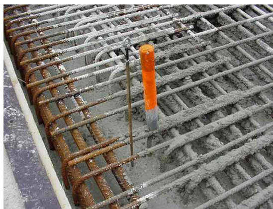
Fig 4.4 Voor het betonneren wordt over de injectie pen een pvc koker geplaatst en oranje geverfd om beschadiging tijdens het betonneren en daarna te voorkomen
