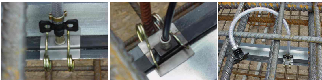
Fig 12.11 Proefstort met een stalen klikvoetje waarop een hd injectieslang was gemonteerd (Calandtunnel) Het klikvoetje is kwetsbaar tijdens het betonstorten of raakt los en de knelverbindingen lekken bij de hoge injectiedrukken door vervormingen.
