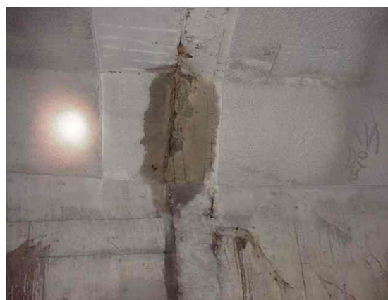
Fig 10.11.2 Inspectie lek 17-5-2004 metrobus H t.p.v. sluitvoeg afzinktunnel
