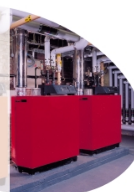
Verwarming wordt hier geregeld met drie in cascade opgestelde CV-ketels.
