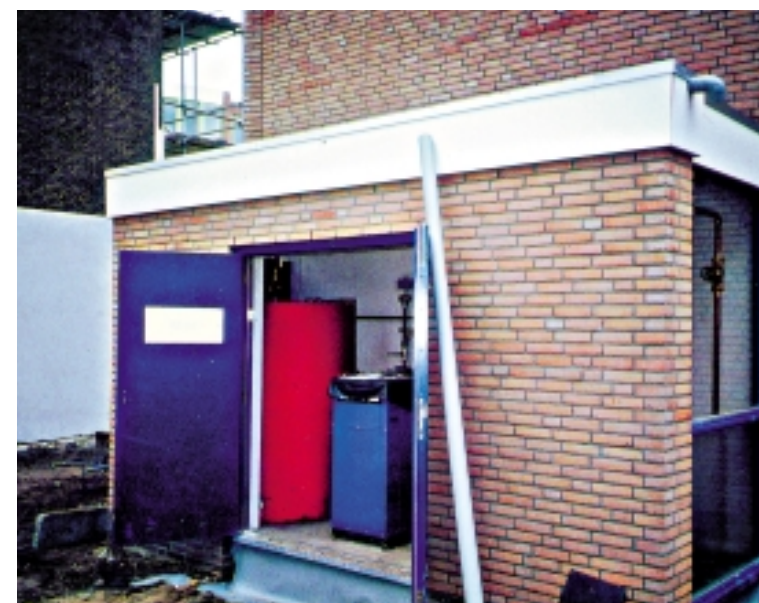
Dit collectieve verwarmings- en warmtapwatersysteem wordt gevoed door 5 warmtepompen. Collectieve elektrische boilers zorgen voor naverwarming.
