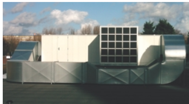
In de luchtbehandelingskast op het dak vindt warmteterugwinning uit ventilatielucht plaats met behulp van een kantelklep-systeem.
