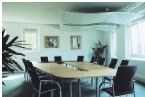
Bij dit lage temperatuurverwarmingssysteem wordt de warmte via klimaatplafonds gedistribueerd.
