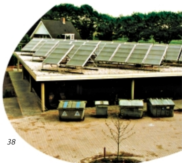
De collectoren van een woongebouw zijn allen op het dak van een bijgebouw geplaatst.
