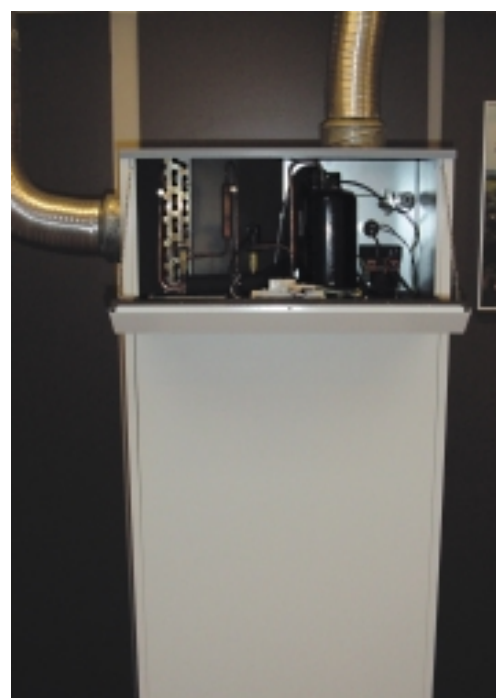
Een warmtepompboiler levert warmte ten behoeve van tapwaterverwarming.
