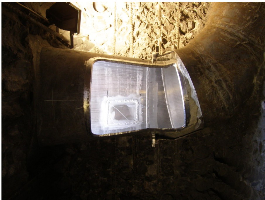
Figuur I.3: Mock-up: reparatie reducer in geboorde werkrimte. De grote opening verschaft toegangsruimte voor reparatie van binnen uit.
