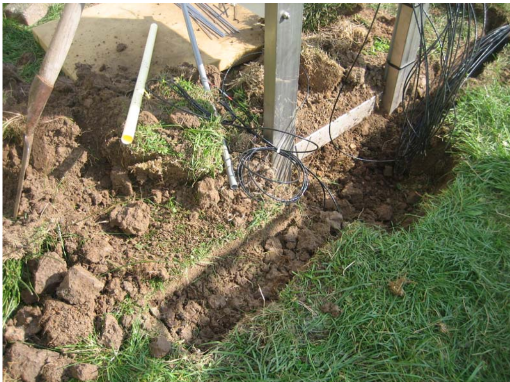
Figuur 7 Naast de SIAM-kast is een sleuf uitgegraven waarin de referentiesensoren worden ondergebracht.
