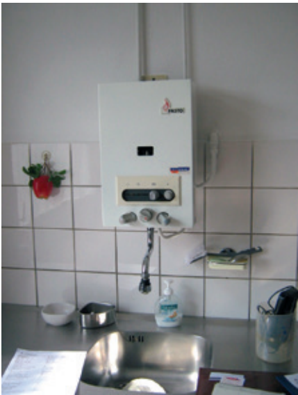
Keukengeiser in bestaande situatie
