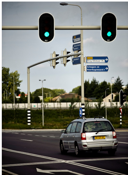
Figuur 5.1: Voorbeeld van een verkeersregelininstallatie op een gelijkvloerse kruising
