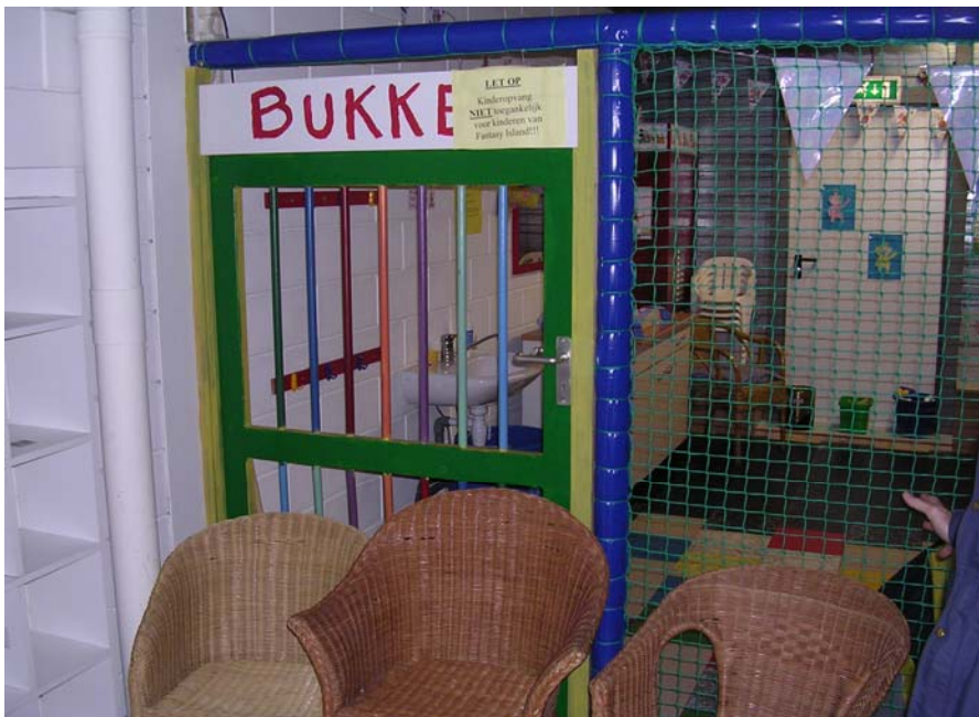
Door net en afgesloten spijlendeur onbereikbaar gemaakte vluchtdeur (witte deur op achtergrond)
