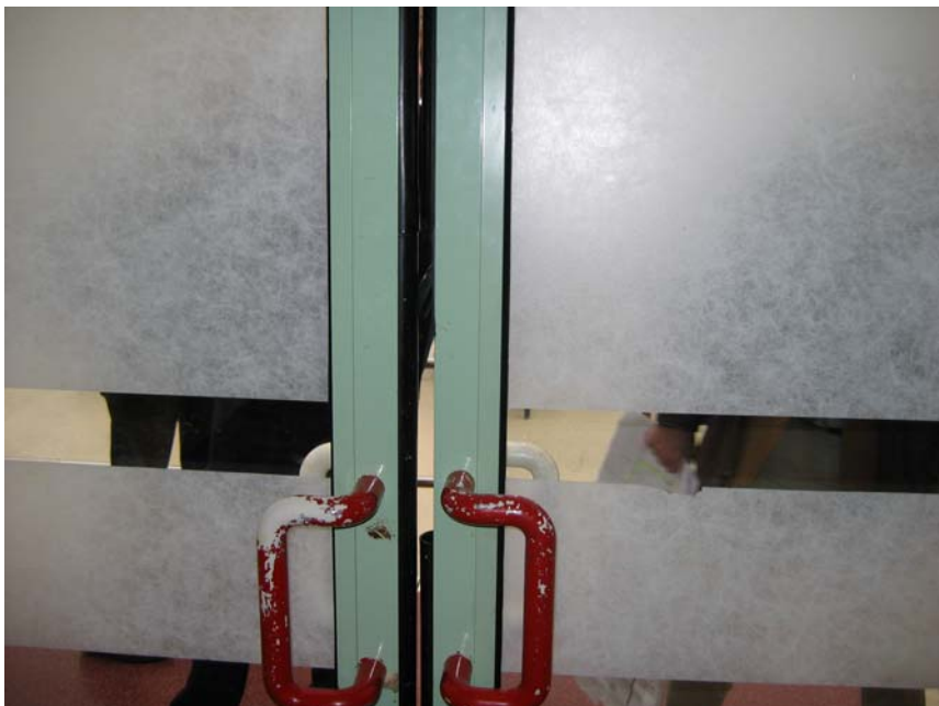
Slecht sluitende brandwerende deur
