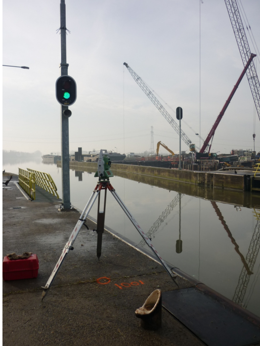
Figuur 4: Opstelling Total-station boven meetspijker, nabij sluisdeuren aan de bovenzijde van sluis Born.
