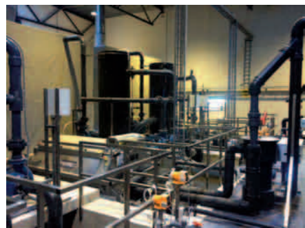
De installaties bij HESY.
