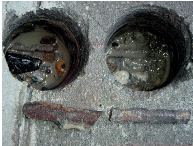
Figuur 3-5 Destructief onderzoek corrosie wapeningsstaal.
