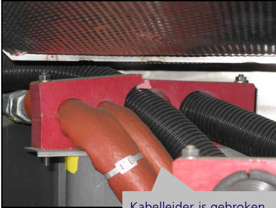
Kabelleider is gebroken
