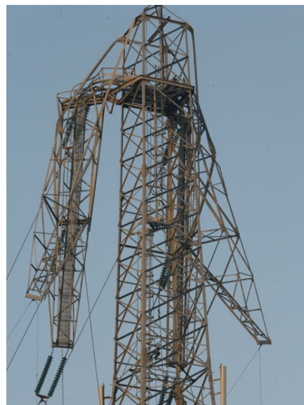
Figuur 8: Beschadiging van dubbelcircuit mast door helikopter.
