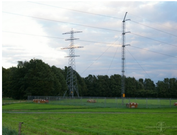
Figuur 11: Installatie van een noodmast vraagt veel ruimte, hier een noodmast 110kV-enkelcircuit.
