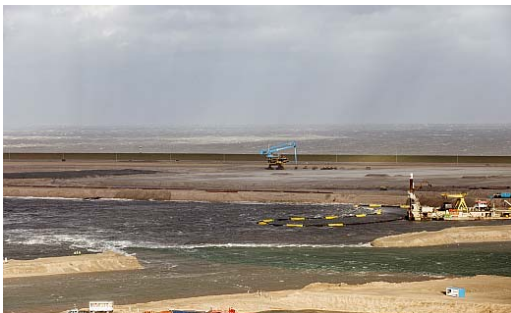
Foto: Dijkdoorbraak Yangtzehaven (november 2012)
