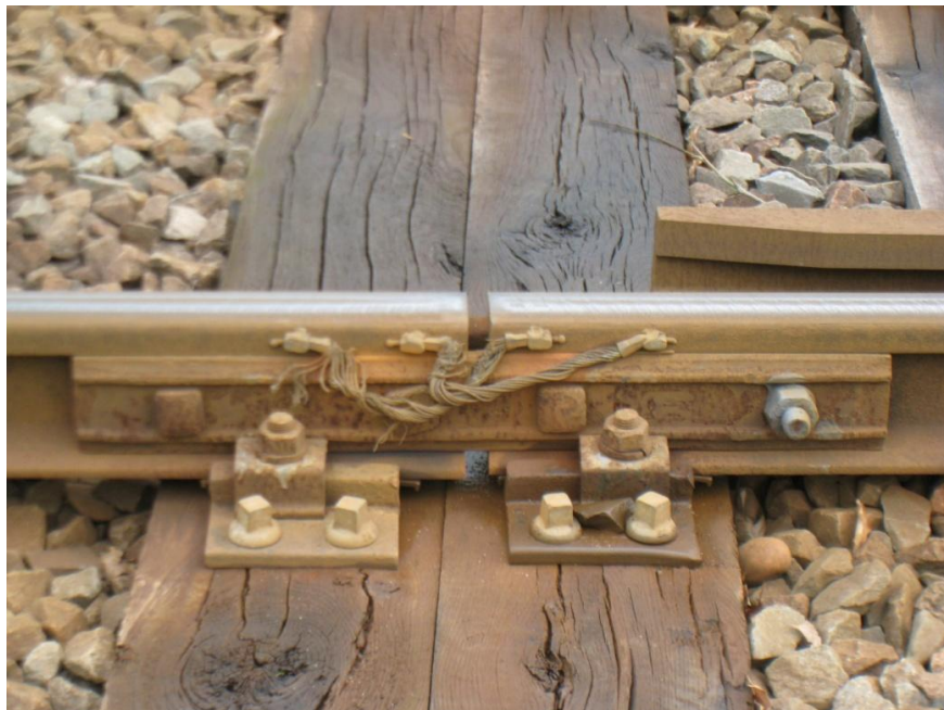
Figuur 5. Foto van opening van 20 mm in las, en ontbrekende boutverbinding.
