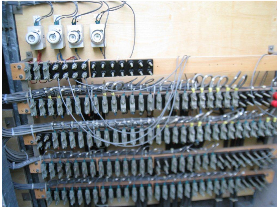
Figuur 8. Foto van slipdraden in een relaiskast. Horen niet voor te komen in een installatie en na een storing hersteld te worden.
