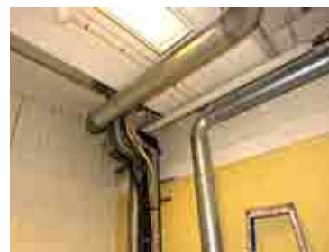
Afb. 326. Installaties, doorlopend tussen compartimenten, 2014
