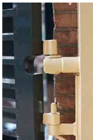
Afb. 356. Toegevoegde verbinding om de luiken mechanisch bedienbaar te maken, 2014
