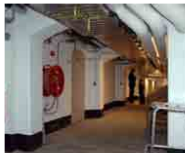
Afb. 355. Installatietracees via de kelders, 2014
