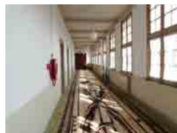
Afb. 411. Galerij met een tijdelijke afwerking waar structuurherstel heeft plaatsgevonden, tweede verdieping van het Stadhoudelijk Kwartier. Ook de dichte deur naar het trappenhuis van Peters is een tijdelijke oplossing, 2014
