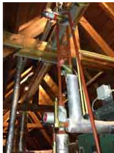
Afb. 354. Wirwar van installaties, 2012
