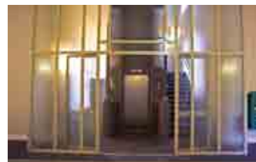
Afb. 432. Brandpui om het trappenhuis met lift in Koloniën, 2014
