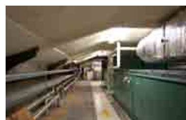
Afb. 325. Installaties, doorlopend tussen compartimenten, 2014
