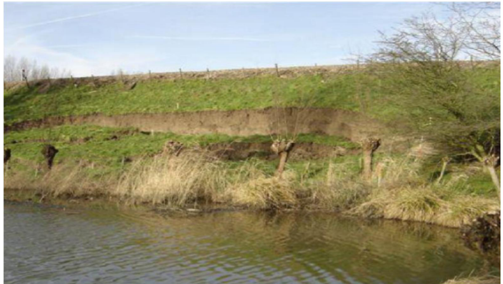
Fig. 2.1: Afschuiving door stabiliteitsproblemen aan de binnenzijde van een dijk
