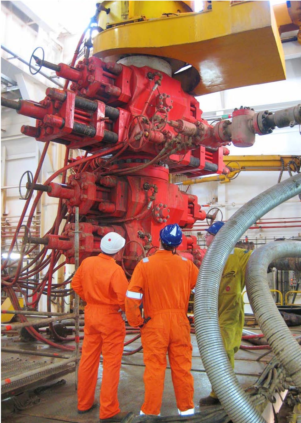
Senior inspecteur Rob Kracht controleert een putbeveiligingsinstallatie - BOP (foto SodM)
