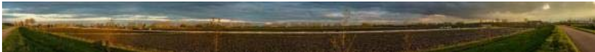
Figuur 18: Uitleglocatie boring van ca. 800 meter, de langste boring in de Noordring.
