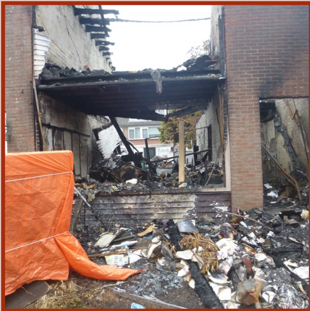
Fig. 6: Wat overbleef van de brandwoning
