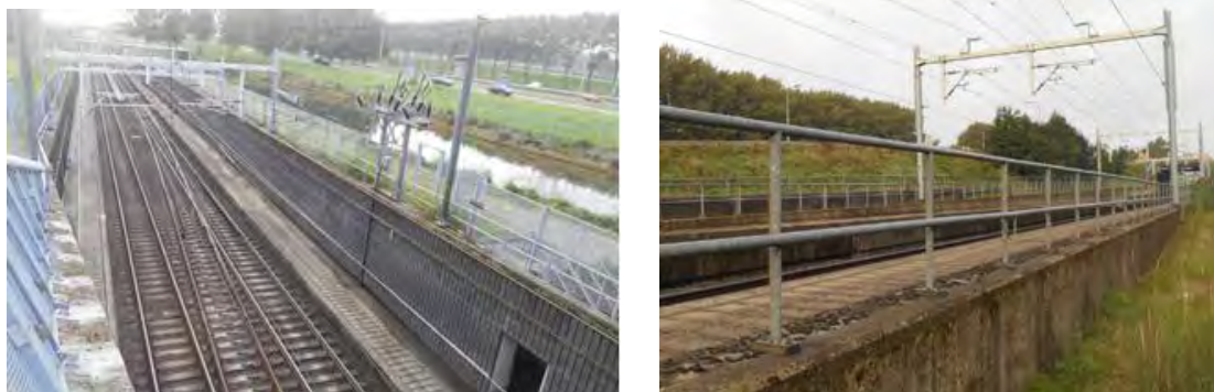
Afbeelding 1.3. en 1.4. Open bakken Oostelijke toerit Sophia Spoortunnel
