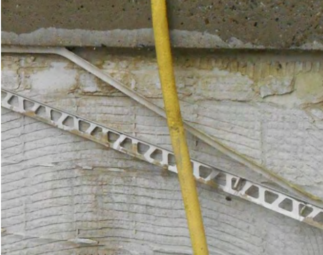
Afbeelding 1.2. Delaminatie tussen tegelwerk en lijmlaag
