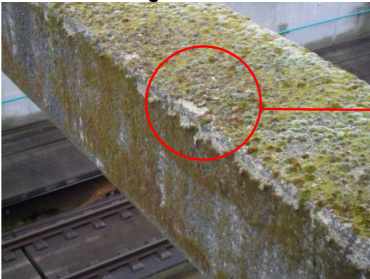
Foto 1.3. 'Peeling' van de betonhuid
