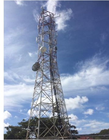
FIGUUR 1: Mast op St Eustatius
