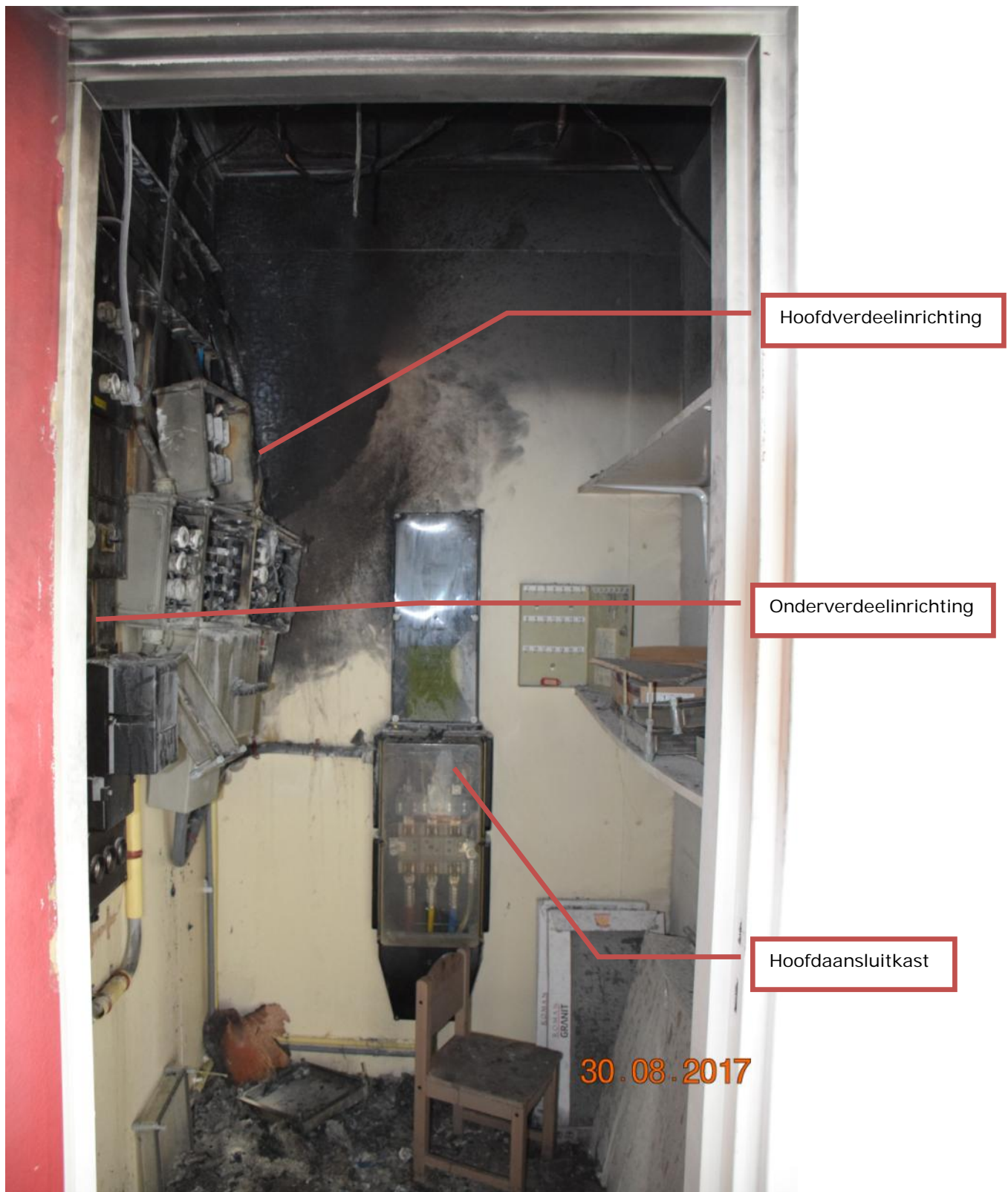
Foto 2 Binnenzijde meterkastruimte, ongevalslocatie
