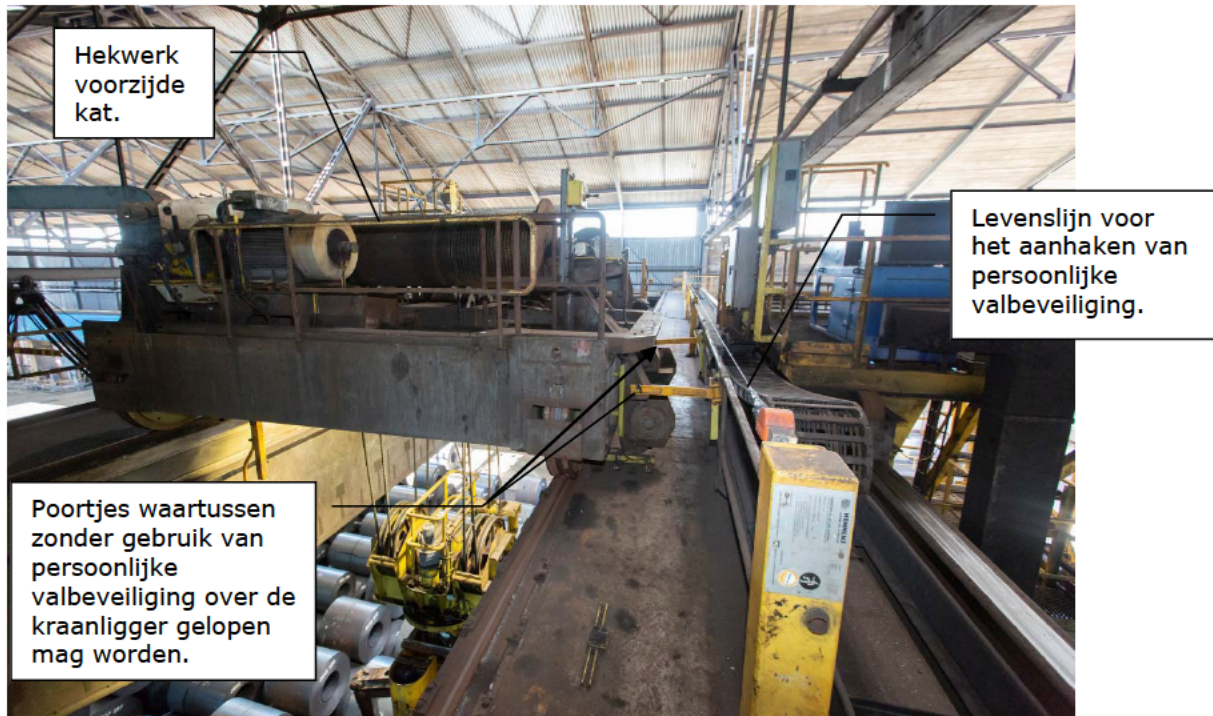
Foto 7: Zicht vanaf de kraanligger op de voorzijde van de kat.
