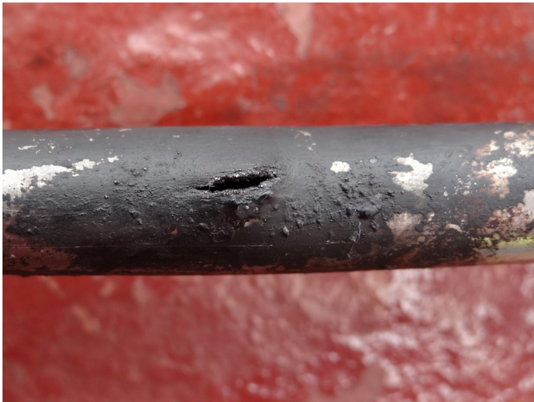
Foto 6, detailfoto van een stuk van de hydrauliekleiding. Hierop is (vergroot) te zien dat er een gaatje in de leiding is ontstaan.
