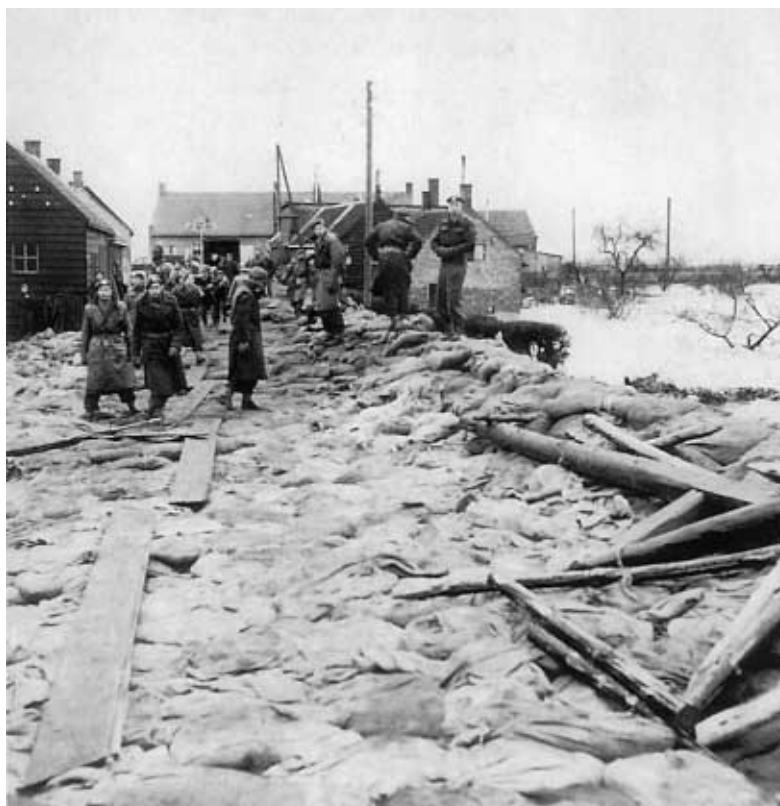
De door militairen, waaronder leden van het Korps Commandotroepen, aangelegde nooddijk bij Zwingelspeen, West-Brabant, tijdens de watersnood van 1953. Foto: SMG-KI.
