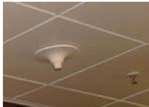
Figuur 5, voorbeeld van een picocel-antenne, vergelijk de sprinkler sproeikop rechts.
