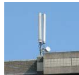
Figuur 16, een GSM-Rail-antenne
