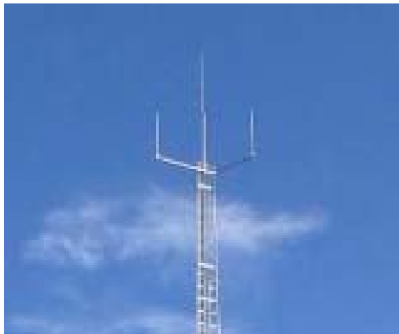
Figuur 2. Voorbeeld van C-2000 en P-2000. Op deze mast ziet men hier dus twee antennes, 1x C2000 en 1x P2000.
