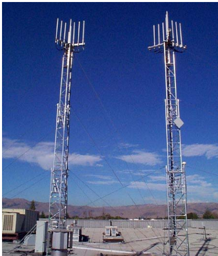
Figuur 21, een iBurst-antenne-installatie
