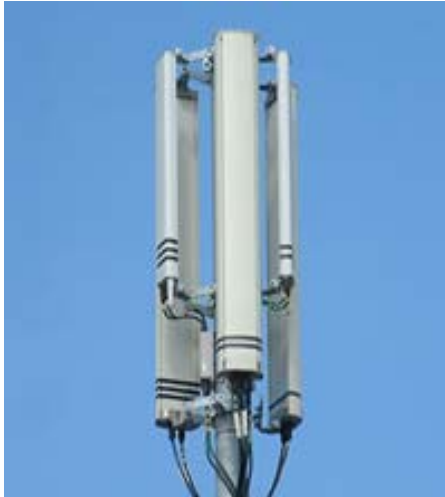
Figuur 4, een typische GSM-/UMTS-antenne op twee frequenties met ieder drie sectoren. GSM is het langere element, en UMTS de kortere. (KPN geeft het nummer van de sector aan met dwarsstrepen op de antenne.)
