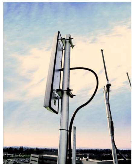
Figuur 20 een WiMAX antenne
