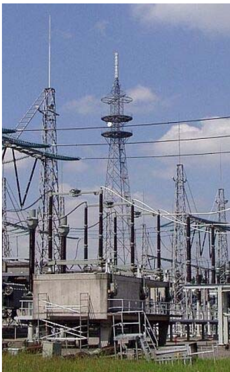
Figuur 13, een antennemast en antenne voor een DVB-zender (Krimmen a/d IJssel)
