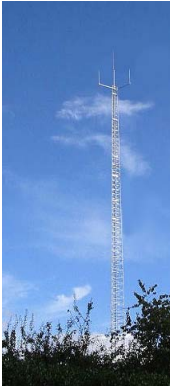
Figuur 14. Een ongedeelde C2000-mast.
