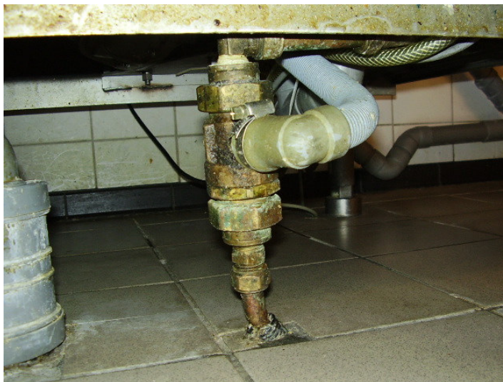
Verkeerde beveiliging met eigen 'afvoer' van overdruk water
