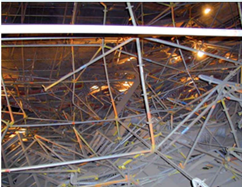
Figuur 9 Ingestorte steiger
