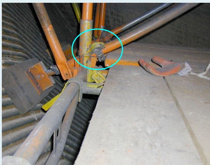
Figuur VII-3 Extra koppeling aan verkeerde kant gemonteerd (antislipkoppeling)
