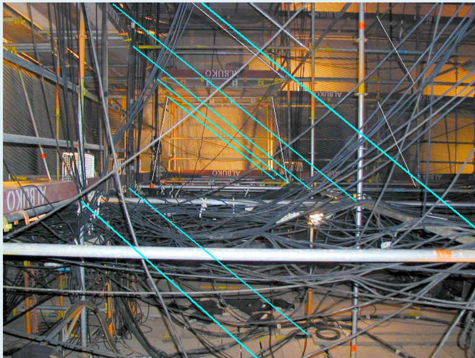
Figuur VII-1 Ontbrekende schoren op de 21-23-meter- en 23-25-metervloer met blauwe lijnen aangegeven
