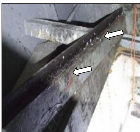
Fig. 17. Lichte schade aan geleiderails
