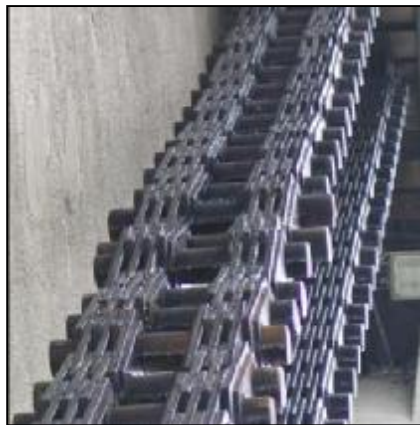
Fig. 15. Geknikte ketting onder volledige belasting van ca. 4000 kN (inspectierapport Klein Mechaniek van 19 april 2007)
