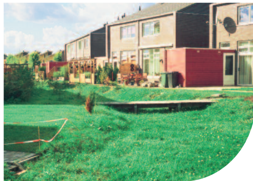
Afb. 10: Wadi in Enschede. Het aanleggen van een wadi-systeem (zie par. 6.2) in een nieuwbouwwijk lijkt op het eerste gezicht een dure oplossing voor het afkoppelen van het regenwater. Maar uit berekeningen en ervaringen in de wijk Ruwenbos in Enschede (lit. 9) blijkt dat deze oplossing vrijwel even duur is als een standaardoplossing met een regenwaterriool, zowel in aanleg als in onderhoud. Bij de wadi's zijn geen regenwaterriool, geen straatkolken en geen watergangen nodig. Er is bovendien veel minder tijdelijke opslag nodig in de vorm van vijvers. In Ruwenbos is ook veel minder verharding toegepast, hoewel dat niet direct met de wadi's te maken heeft. Er is wel meer 'groene' ruimte nodig voor de wadi's.
