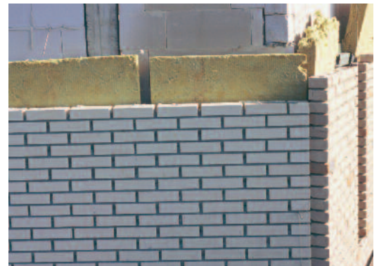
Afb. 27: Een zeer zorgvuldige uitvoering is gewenst. Zo dient de isolatie in de spouw goed aan te sluiten op het binnenspouwblad. Bovendien moeten de isolatieplaten goed op elkaar aansluiten.
