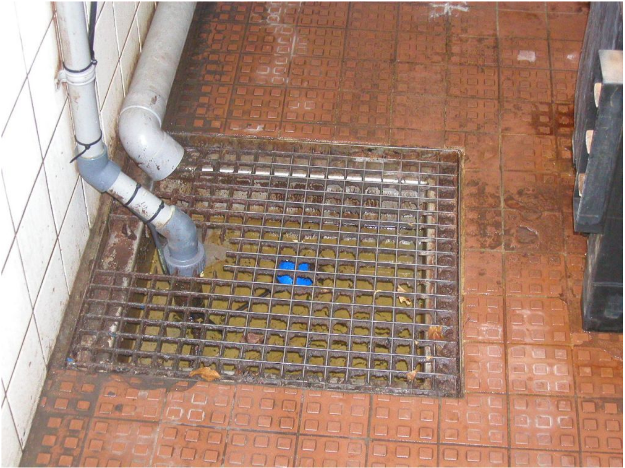
Figuur 5: een vloer bij een galvanisch bedrijf waarvan niet kon worden aangetoond dat deze vloeistofdicht was.
