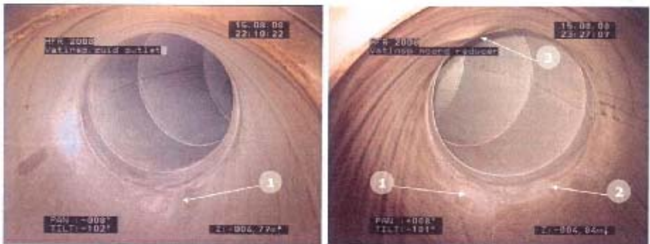
Figuur 5: Vervormingen in de zuidelijke reducer (links 1*) en de noordelijke reducer (rechts 3*). Tijdens inspecties in 2008 is een gasbellenspoor aangetroffen in vervorming 2 van de noordelijke reducer.
