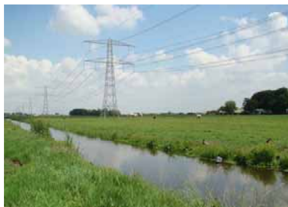
Voorbeeld huidige situatie: een 2 circuitsverbinding in een vakwerkmast
