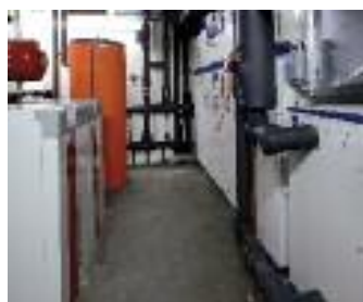
Kaatsheuvel, 'De Horst'. Installatie die zowel woningen als kantoren van warmte en koeling voorziet.
