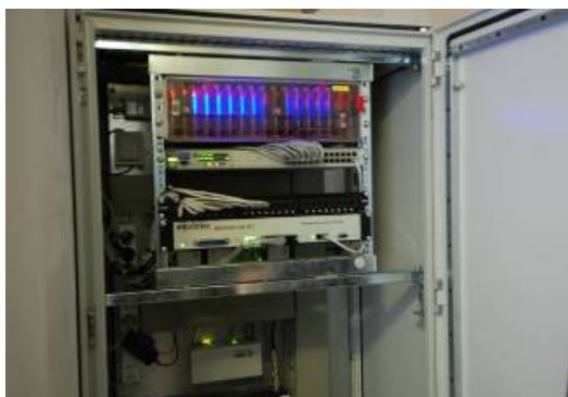
Centrale installatie in ADL-unit van het Alarm Intercom Systeem
