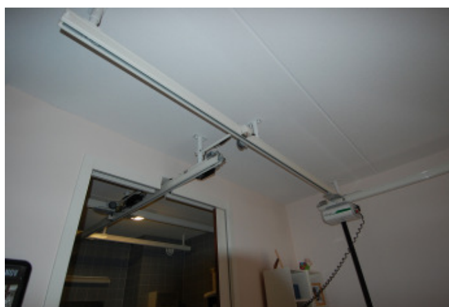
Plafondtilliftsysteem van slaapkamer naar badkamer
