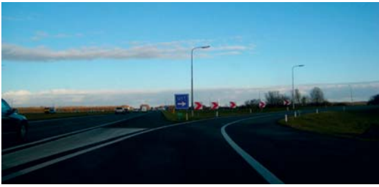
Afrit 7 HRR, overgang van wegdek bij afrit, ter hoogte van deze overgang zit tevens de "kuil".
