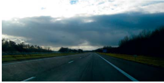
Slecht wegdek (voegovergangen lengterichting en spoorvorming).
