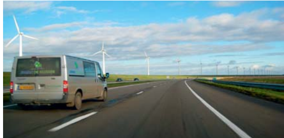
Zeer slecht wegdek, gaten in voegovergangen rijrichting (tussen rijstrook 1 en 2). Daarnaast is goed te zien dat onder andere op deze locatie de vluchtstrook vrij smal is, en direct daar aan grenzend de geleiderail is geplaatst (bij pech kan men niet half in de berm gaan staan, maar staat direct (kort) langs de rijbaan).
