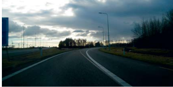
Tijdelijke belijning nog steeds zichtbaar op afrit aansluiting 11.
