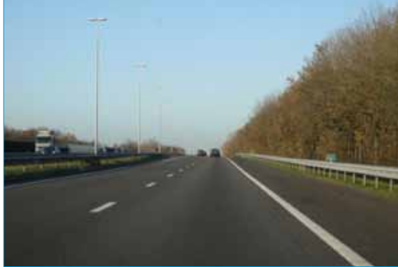
Foto 1: De topboog in de rechtstand tussen de aansluitingen Apeldoorn en Apeldoorn-Noord (hm 208,4) beperkt het zicht op het verloop van de weg (zie ook de onderstaande foto na de topboog)
