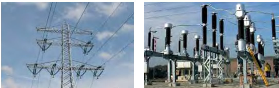
Figuur 3.26 Hoogspanningsmast en verdeelstation (voorbeelden)
