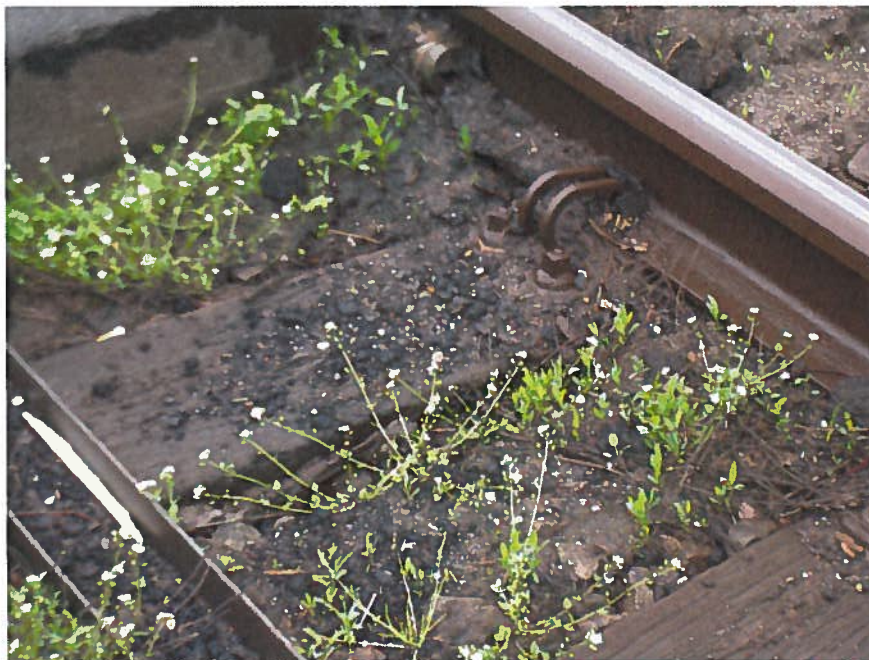
Figuur 20. Klapper bij overweg in Gelre. De weggespoelde grond rondom de dwarsligger en de begroeiing is duidelijk te zien.
