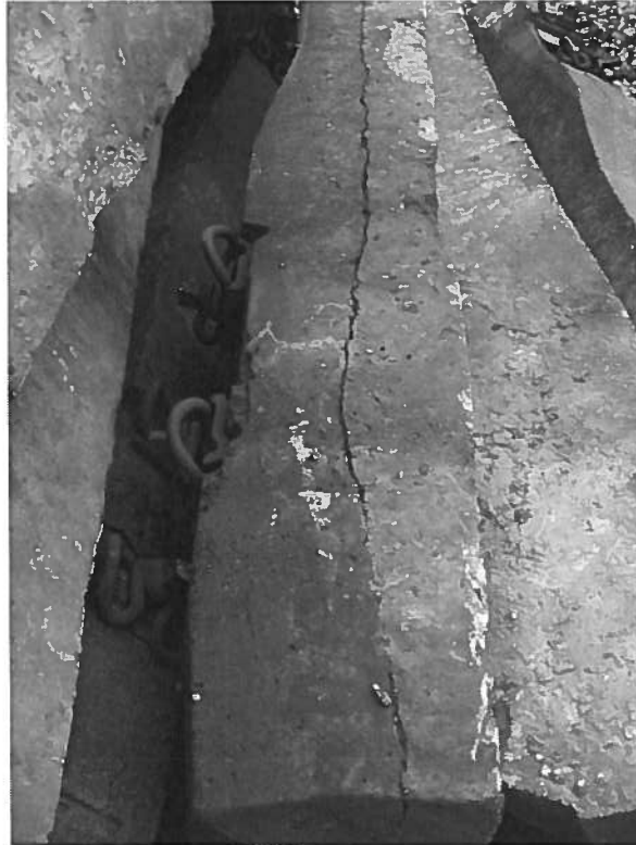
Figuur 6. Scheur in betonnen dwarsligger te Baarn, van de zijkant gefotografeerd, na verwijdering
