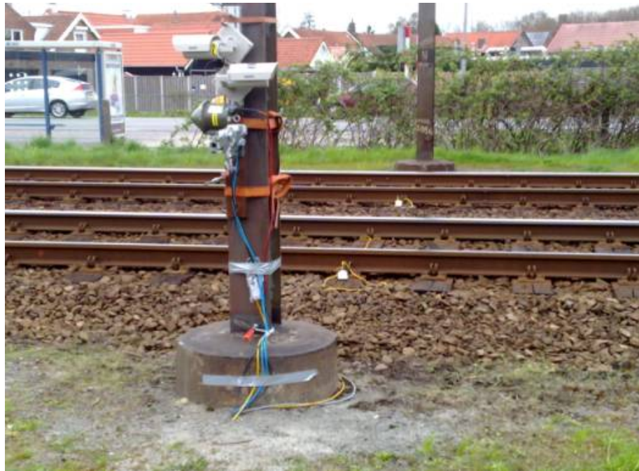
Figuur 13: Apparatuur ter hoogte van het referentiepand aan Parallelweg 4. In de foto zijn de twee van de vier trillingsopnemers op de dwarsdragers van het spoor, de radar en de video camera's zichtbaar.
