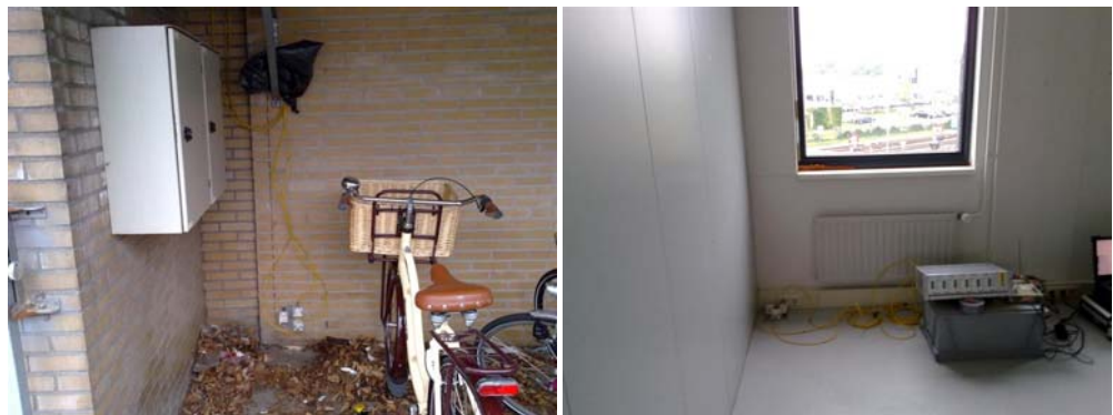
Figuur 4: Versnellingsopnemers ter plekke van de fundering (links) en op de eerste verdieping (rechts) bij de referentieband aan de van Dusseldorpstraat nr.5.
