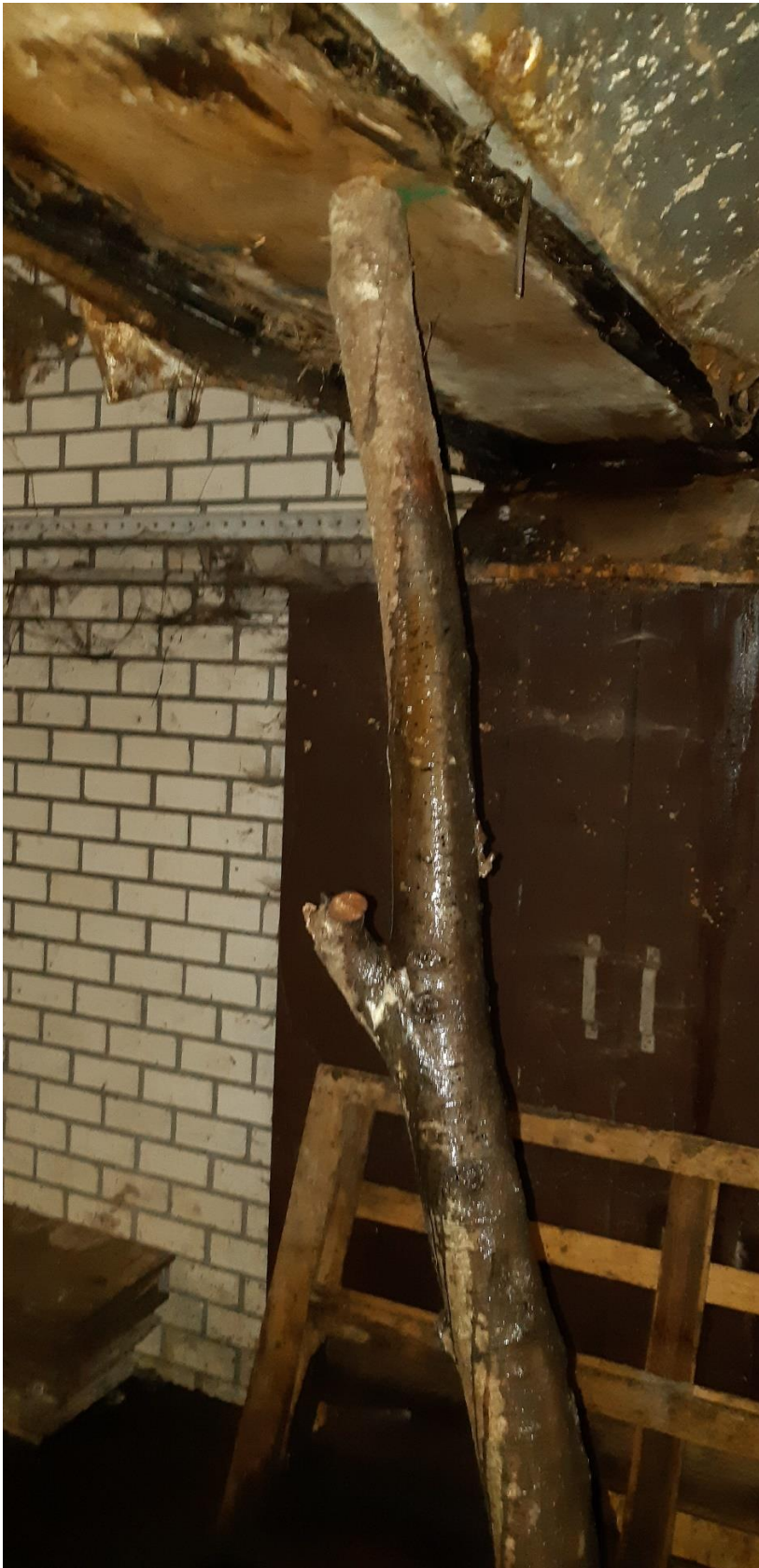
Foto lekkend dak / plafond. Wordt ondersteund door houten paal zodat het dak / plafond niet naar onder valt.
