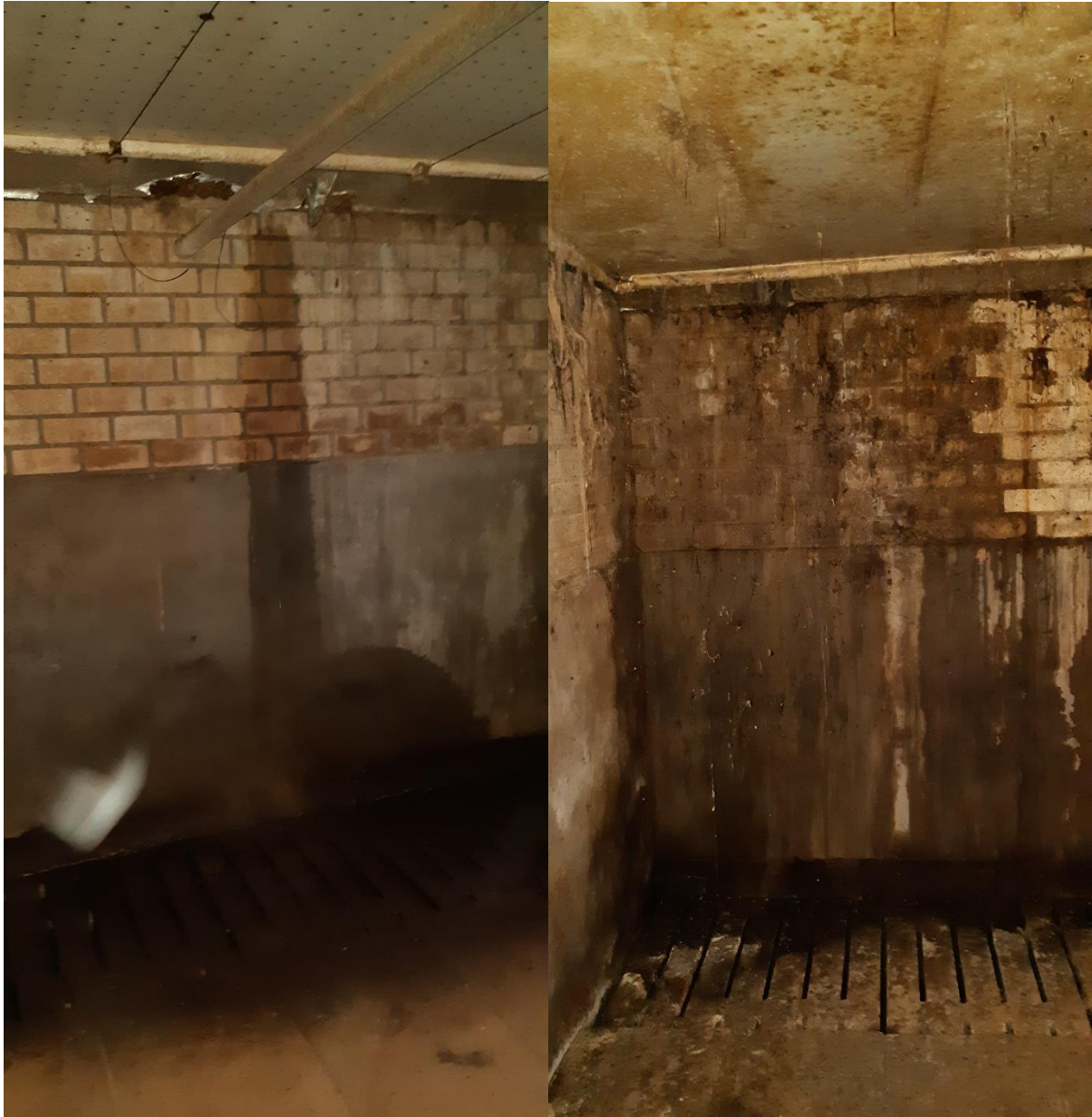
Foto's van lekkend dak in de vleesvarkens afdeling.
