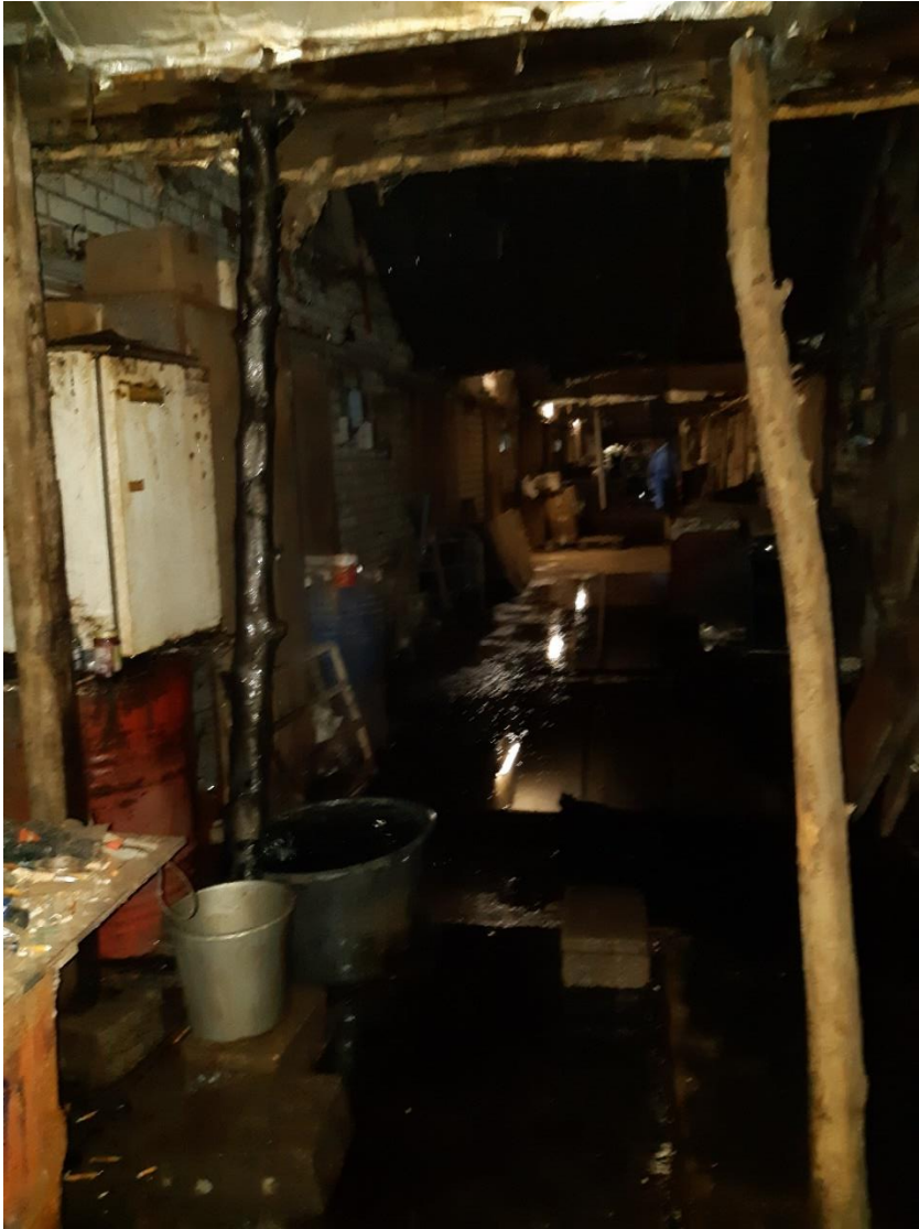
Foto 2 van centrale gang, waarvan delen onder water staan vanwege het binnen komend regenwater.
