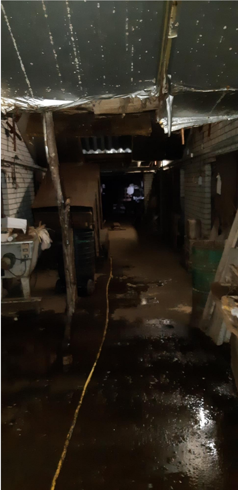
Foto van centrale gang, waarvan delen onder water staan vanwege het binnen komend regenwater.
