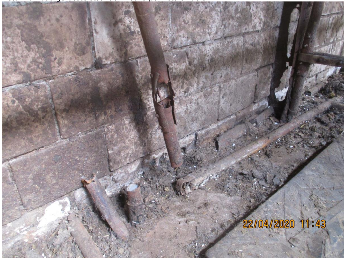
Detail van doorgeroeste staander – scherpe metalen delen:
