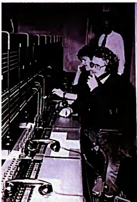
113. Oorlogs Militaire Eind Centrale Den Haag (OMEC GV) in ruimte 028. Jaartal onbekend, maar waarschijnlijk omstreeks 1980. (Herkomst: Historisch Collectie Verbindingsdienst, Amersfoort)
