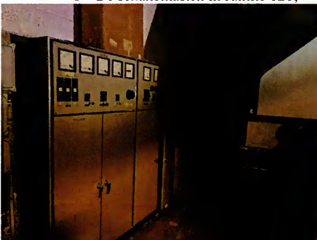
o De schakelkasten in ruimte 020;
