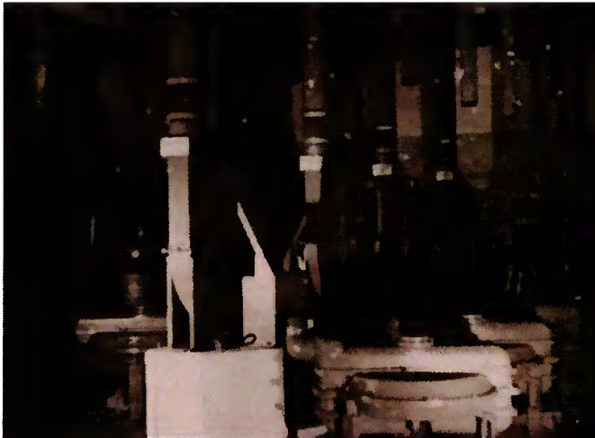
79. Ruimte 020 met de Duitse luchtzuiveringsinstallatie, gezien richting de noodoosthoek van deze ruimte. Op deze afbeelding is te zien dat de luchtinlaatbuis (noodoosthoek van de machinekamer) tijdens de Tweede Wereldoorlog op dezelfde locatie zat als tijdens de Koude Oorlog. Foto 1947
