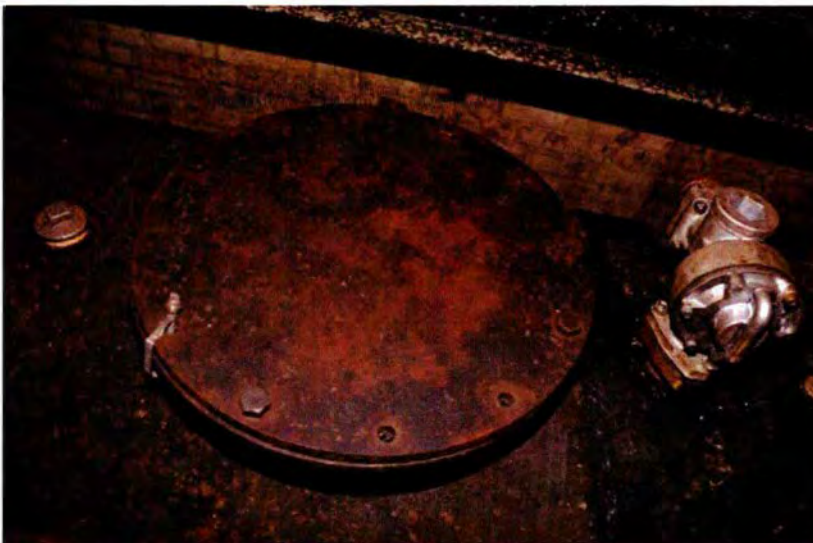
423. Ruimte 097. Een van de deksels waarmee de vaten zijn afgesloten. Het deksel zelf zal nog uit de bouwtijd dateren. De afsluiter rechts zal bij aanpassingen in de KO behoren. Alle drie tanks zijn voorzien van deze onderdelen.
