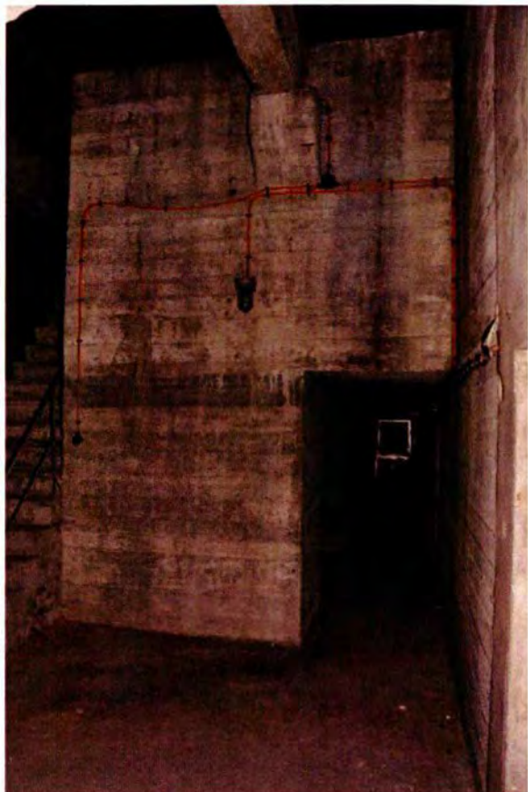
656. Ruimte 202 naar het noorden. Zicht in de gang naar het trappenhuis (ruimte 204). De doorgang is aan de linkerzijde verbreed (zie ook de plattegrond) om met grotere goederen de bocht vanuit de gang van ruimte 204 te kunnen maken. Links de trap naar de observatietoren.
