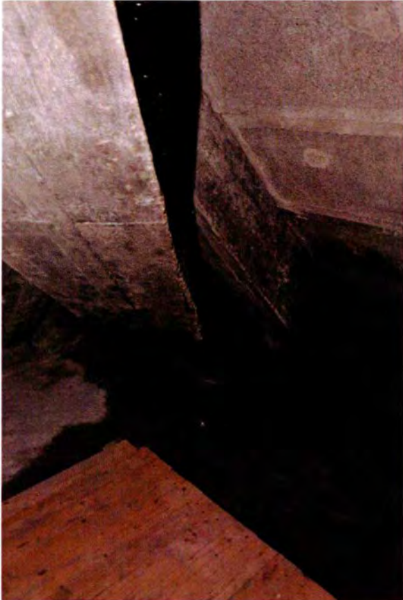
624. Ruimte 162C. Detail van de aansluiting van de noordwestelijke hoekkeper op de betonvloer. Hier is zichtbaar dat de bouw niet vlekkeloos is verlopen. De rechterzijde van het spantbeen verdikt zich aan de onderzijde enigszins. Hier is tijdens het storten de bekisting gaan wijken, waardoor een deel van het beton uit de bekisting is gelopen. Dat is de klomp beton die rechts naast het spantbeen zichtbaar is.
