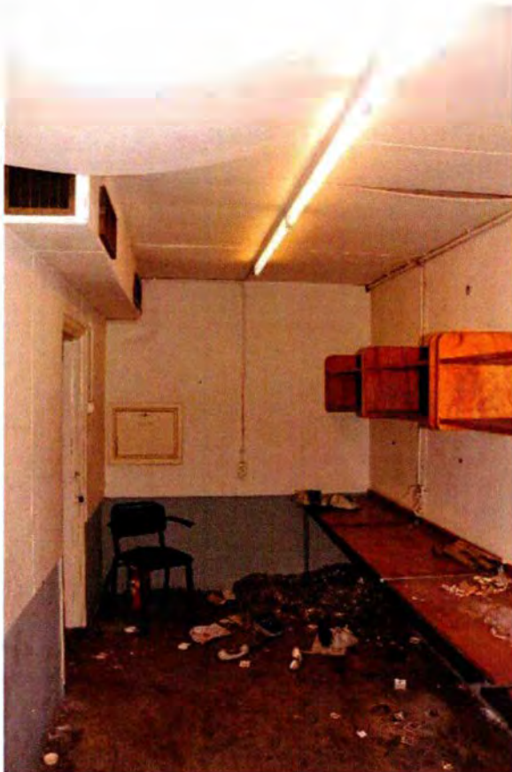
507. Ruimte 137, gezien naar het westen, met links de toegangsdeur met erboven een kanaal van de luchtbehandelingsinstallatie van de KO (1964). In de westwand het doorgeefluik voor berichten naar ruimte 136. Rechts opbergkastjes en werktafels (1964).
