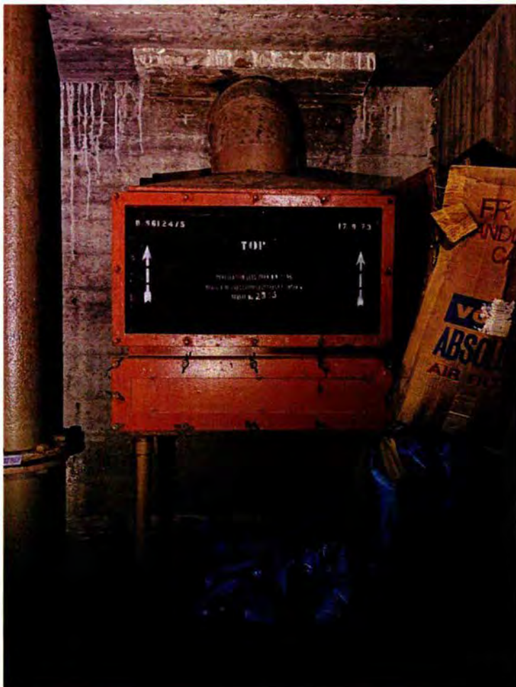
612. Ruimte 99A. Detail van de installatie met fijnstoffilter in de kast.
