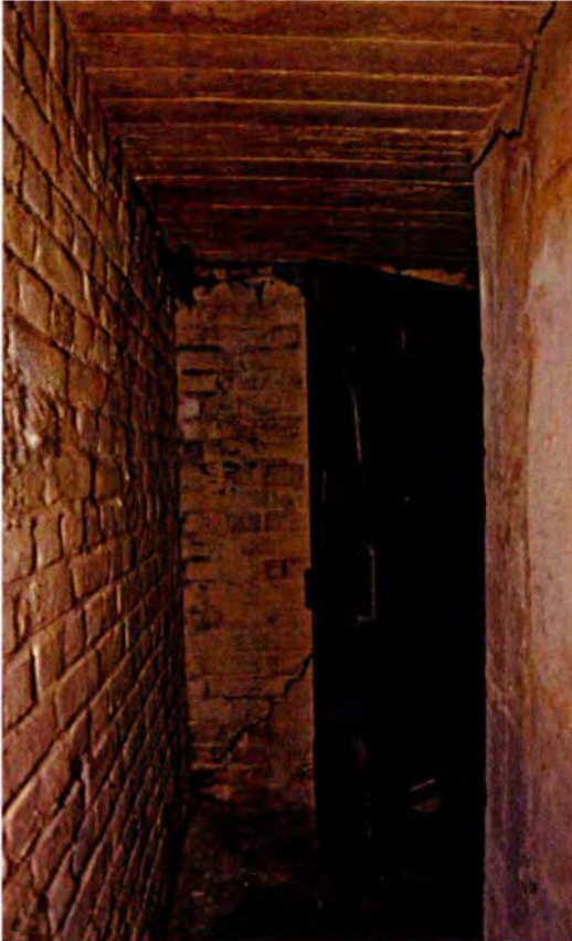
418. De gang gezien in westelijke richting met de stalen deur naar de opslagruimte 097. De deur zal nog uit de bouwtijd zal dateren. Achter de deur de kopwand met schuin oplopende scheur.
