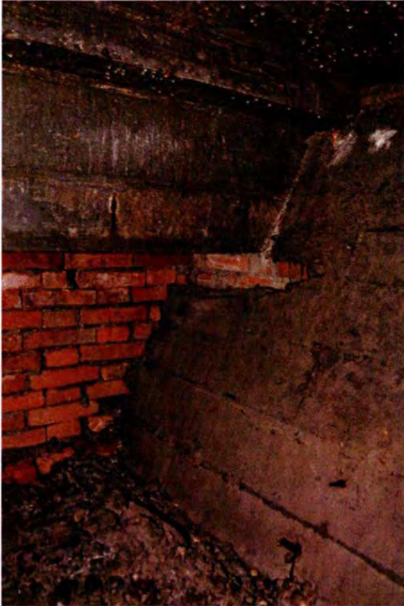
458. Ruimte 80A. Detail van de zuidwesthoek. Hier is bij de aansluiting van de randbalk op de westwand nog een klein deel van de bakstenen beklamping van een dragende kolom zichtbaar. Het beton van de zijwand is tegen het baksteen metselwerk van de kolom gestort.
