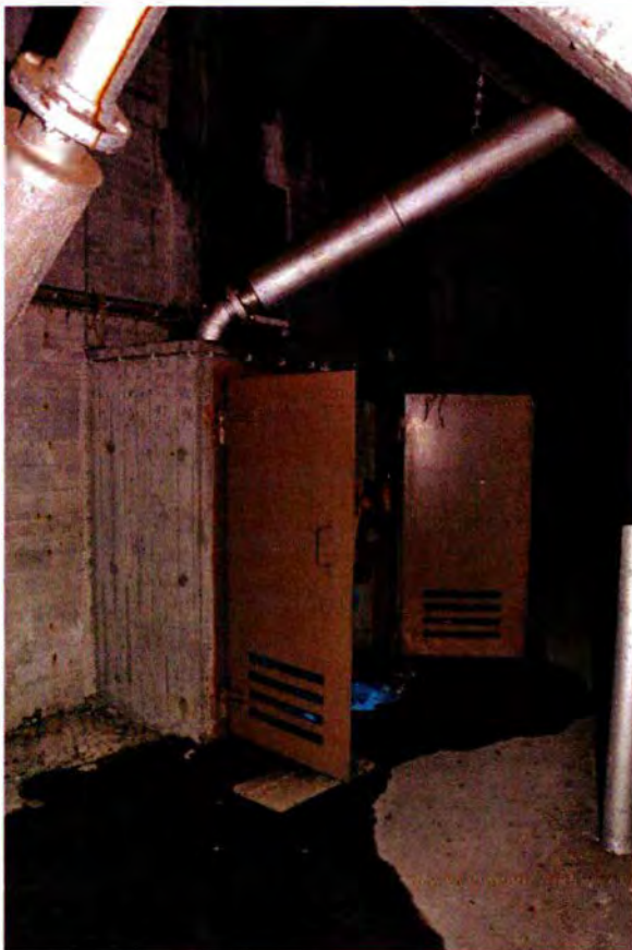
610. Ruimte 99A. De betonnen filterkast wordt met twee stalen deuren afgesloten. In de deuren zijn luchtsleuven uitgespaard. De kast is geplaatst bij de modernisering van de luchtverversing (1956).
