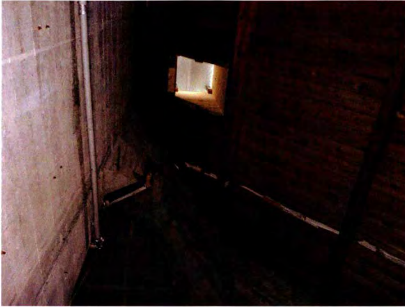
630. Ruimte 162D naar de zolder gezien. Het gat in het dak is het restant van de schoorsteen die vanaf de garage (ruimte 094) naar het dak ging en die bij werkzaamheden in 2019 is verwijderd. Het houten dak is in na WOII (1948) aangebracht om de schade van een bominslag te herstellen.
