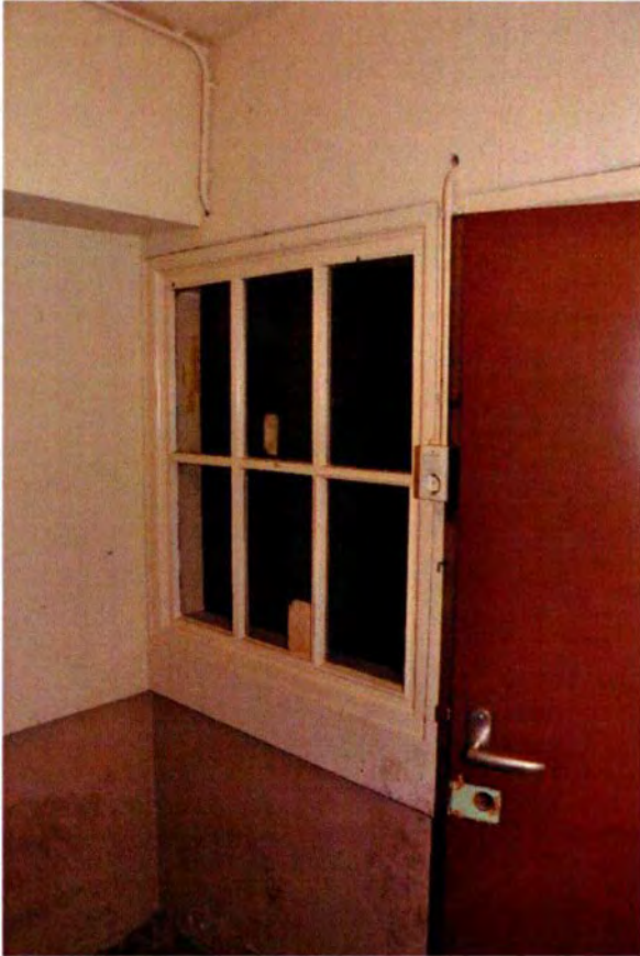
588. De noordoosthoek van ruimte 159. Linksboven is het luchtverversingskanaal uit de KO (1964) zichtbaar. De deur en het venster zijn ook in de KO-periode (1948) tot stand gekomen. Het bovenste deel van de wanden en het plafond zijn afgewerkt met zachtboard. Het onderste deel van de wanden heeft grijs geschilderd pleisterwerk.
