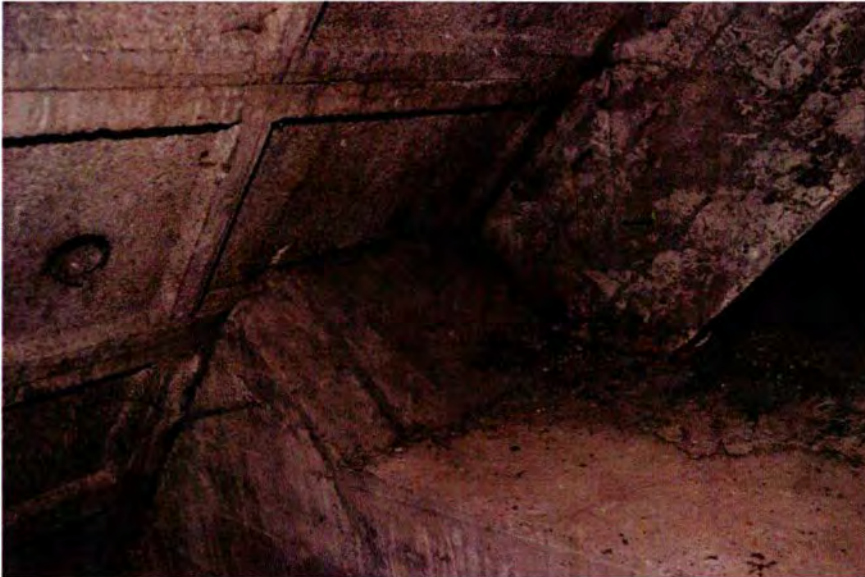
608. Ruimte 162B. Detail van de aansluiting van het schuine dakvlak op het verhoogde deel ter plaatse van de toegang. In de rand van het verhoogde deel is een sponning uitgespaard, waarop de bijgehakte dakplaten rusten.
