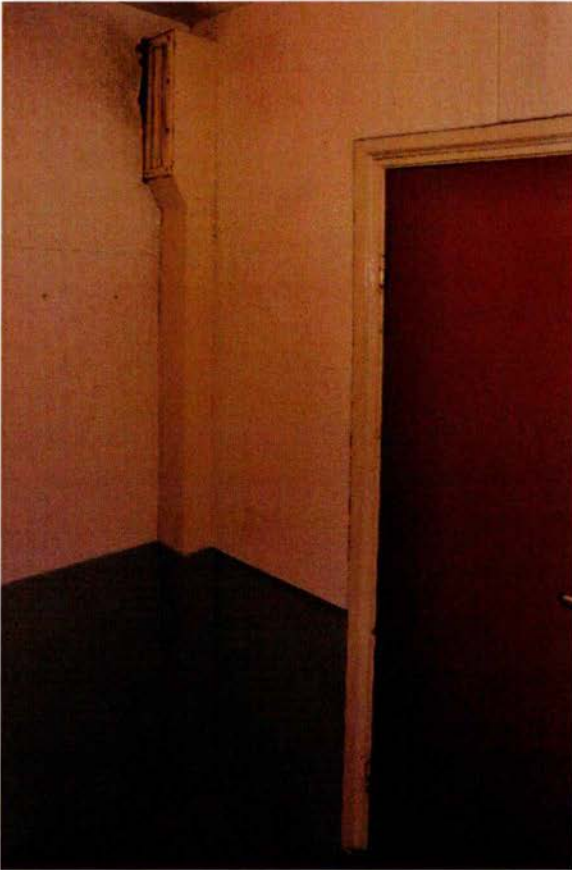
495. De zuidoosthoek van ruimte 133. De toegangsdeur is waarschijnlijk in de KO (1948) in een kozijn uit de bouwtijd geplaatst. In de hoek een rechthoekig blikken luchtbehandelingskanaal, dat daar bij de verbouwing van omstreeks 1964 zal zijn geplaatst.
