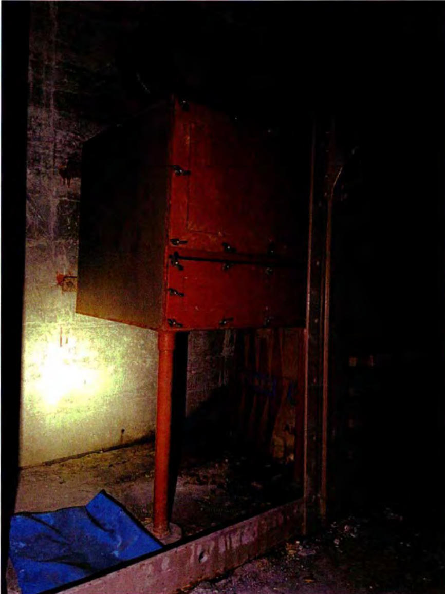
637. Ruimte 162D. Detail van kast 99B in geopende toestand. Zichtbaar is het fijnstoffilter (1956) voor het luchtbehandelingssysteem in de bunker tijdens oorlogstijd.
