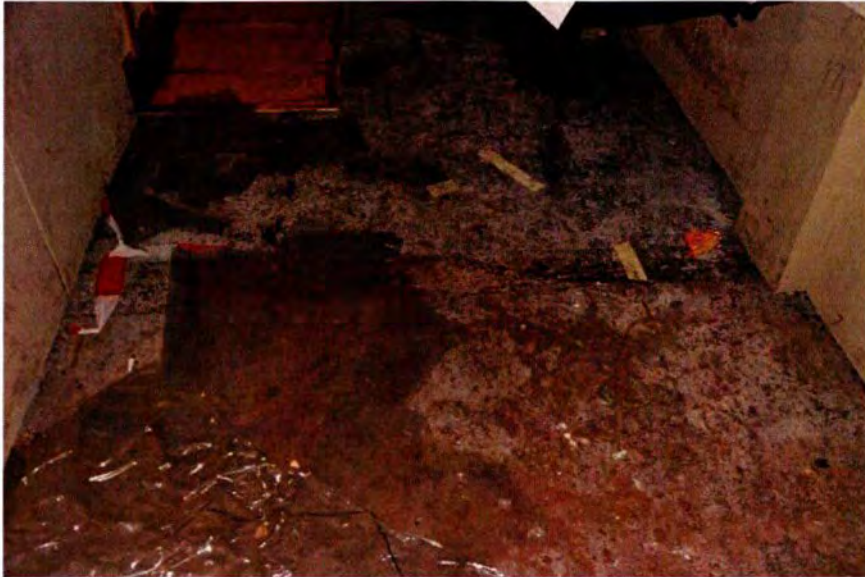
569. Ruimte 151. De magnesienvloer (1948) met een herstelling op de plaats waar oorspronkelijk een tussenwand heeft gestaan.
