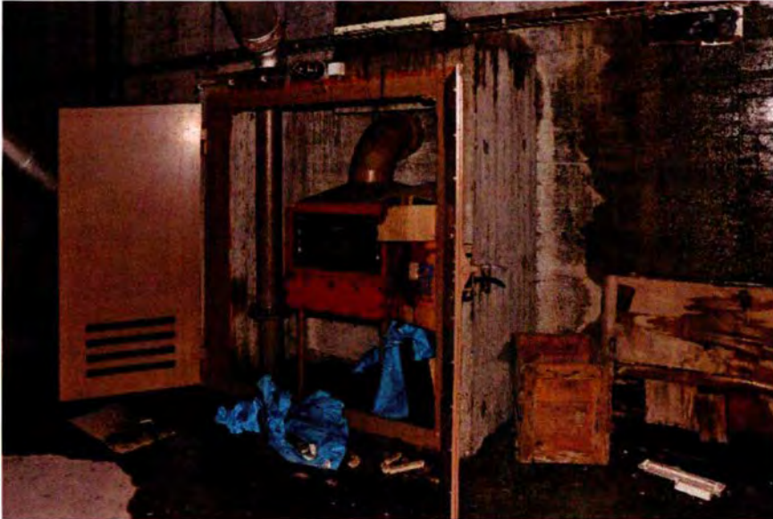
611. Ruimte 99A. Zicht op het inwendige van de kast. De lucht wordt door de sleuven aan de onderzijde van de kast aangezogen. Het fijnstoffilter bevindt zich ter plaatse van het zwarte deel in het midden. De gezuiverde lucht wordt via de leiding aan de bovenzijde van de kast naar binnen geleid.
