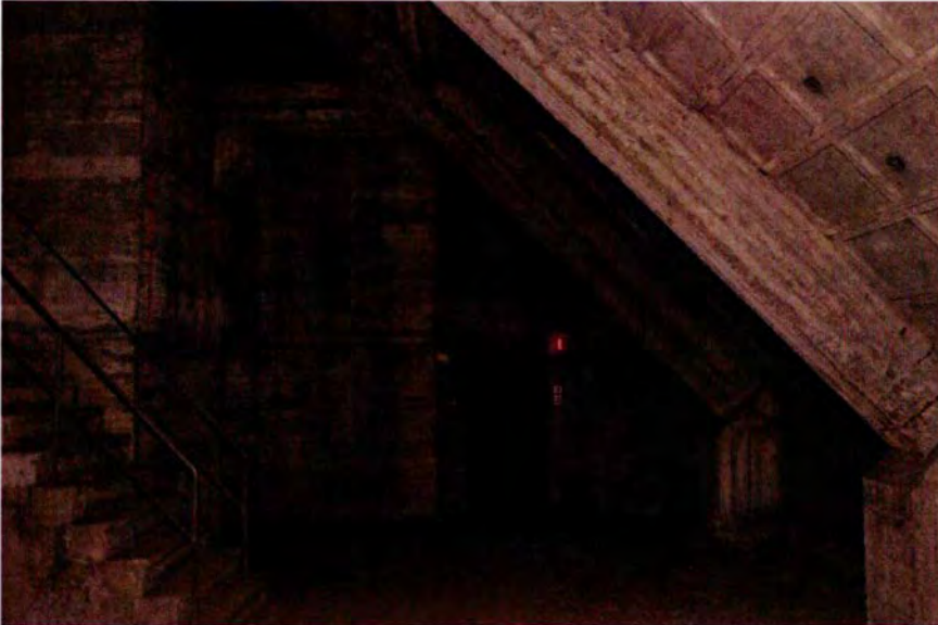
654. Ruimte 202. Het zuidelijke deel van de ruimte, gezien in oostelijke richting. Links het westelijke deel van de opbouw voor de luchtafvoer, trappenhuis en observatietoren. Dit deel is in gewapend beton uitgevoerd. De scheidingsmuur met ruimte 202 (met daarin de hier geopende gasdeur) is als gepleisterde bakstenen muur uitgevoerd.
