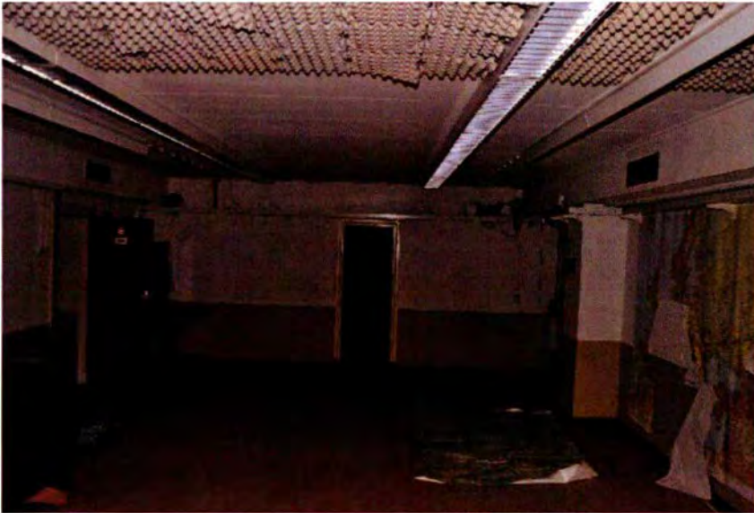
525. Ruimte 140. De oostwand met in het midden de deuropening naar ruimte 139. Deze is in 1948 geplaatst. Links en rechts kanalen van de luchtverversingsinstallatie.
