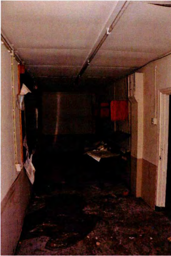
567. Ruimte 151, gezien naar het westen. Rechts de noordwand met de oostelijke toegang en ernaast een dubbele uitvoering van het luchtbehandelingsysteem (1964). In de noordwestelijke hoek (rechts) is nog een luchtbehandelingskanaal zichtbaar.
