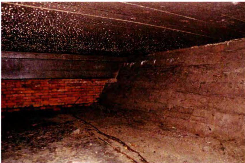
457. De zuidwesthoek van ruimte 80A. Links de randbalk van het overstekende dak. Het metselwerk onder de balk is opgetrokken in Vlaams verband. Rechts de betonnen bovenzijde van de westwand van ruimte 097.
