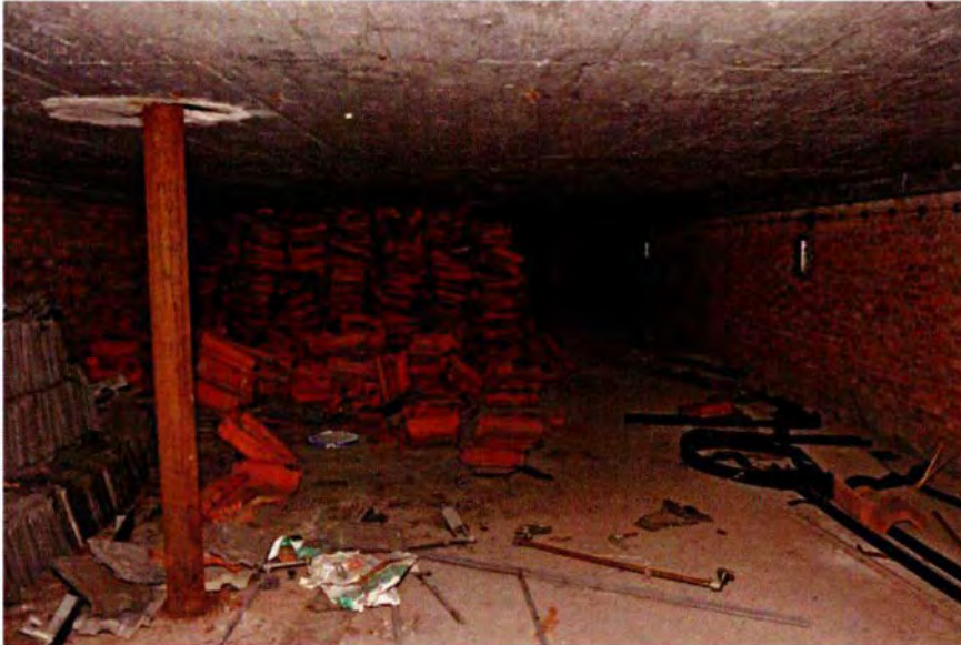
448. Ruimte 80 in westelijke richting. Links een van de in een latere fase door de zoldering gebroken afvoeren. In het midden een deel van de opslag van dakpannen. De noordwand rechts is een spouwmuur in Vlaams verband, die als beklamping tegen de bunker is gemetseld. Geheel aan de achterzijde is de betonnen wand van zijn 80A zichtbaar.
