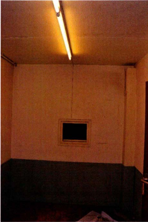
498. De oostwand van ruimte 134 met in het midden een doorgeefluik voor berichten naar ruimte 135. Rechts in de hoek is een van de luchtbehandelingskanalen (1964) zichtbaar.
