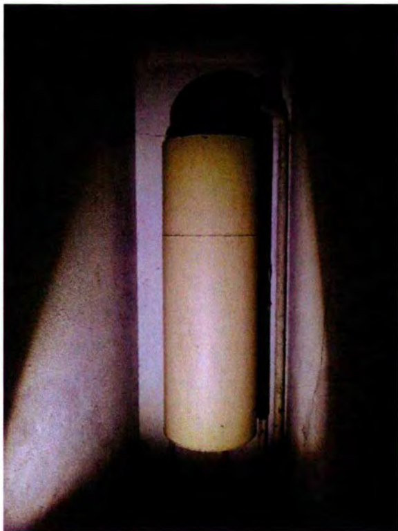
670. Ruimte 204. Direct boven de trap aan de oostzijde hangt aan de muur een overdrukvat voor water. Deze dateert uit de jaren '80 en zorgt voor een stabiele waterdruk in de lager gelegen ruimtes.
