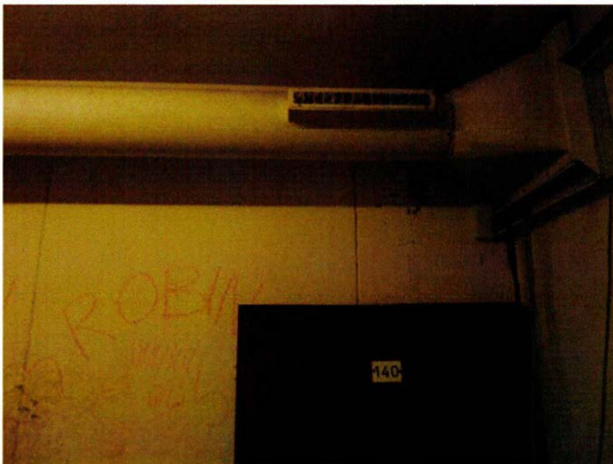
523. Ruimte 139A, gezien naar het zuiden. De mogelijk nog uit de bouwtijd stammende luchtbehandelingsinstallatie.
