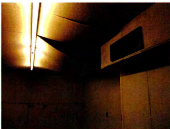
508. Ruimte 137, gezien naar het westen. De plafondplaten zijn hier naar beneden gezakt.
