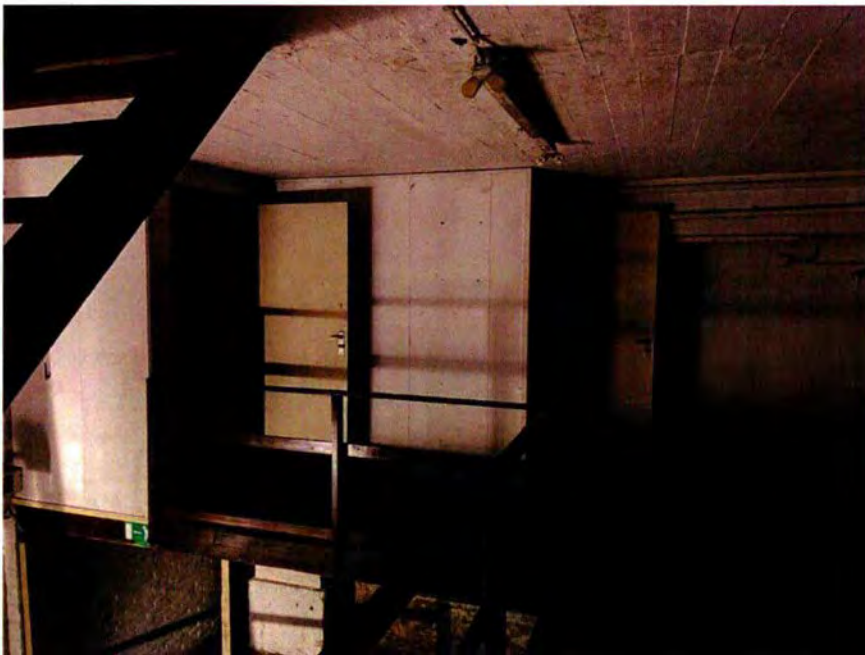
464. Ruimte 93G, gezien in westelijke richting. Hier bevinden zich de toiletruimtes 93C, 93D, 93E en 93F. De houten vloer is in zeer slechte staat, waardoor deze ruimtes niet nader onderzocht konden worden.
