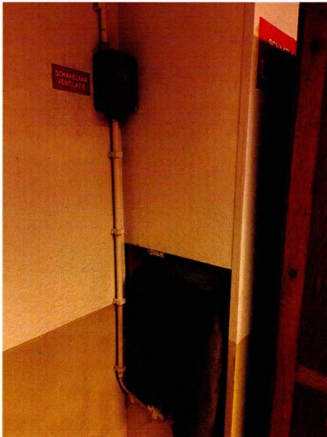
528. Ruimte 140, zuidwand. Detail van de luchtverversingsinstallatie met schakelaar. Op geen enkele andere plek in de bunker is een schakelaar aanwezig voor ventilatie. Onderaan een inkijkje in het luchtbehandelingskanaal.
