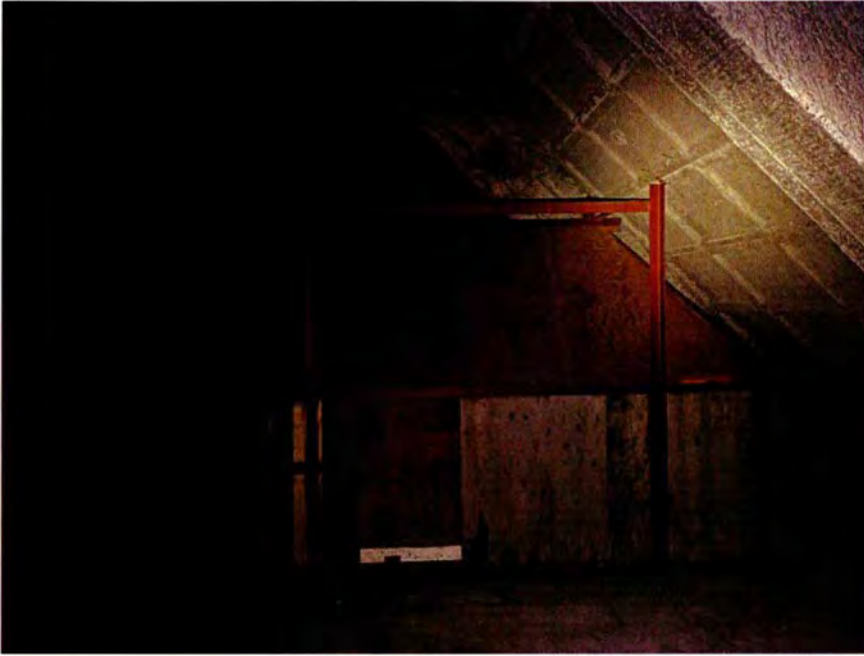
638. Ruimte 162D, in westelijke richting. Midden in beeld de achterkant van de kogelvanger van de schietbaan in ruimte 162C. Links is nog net kast 99B zichtbaar.
