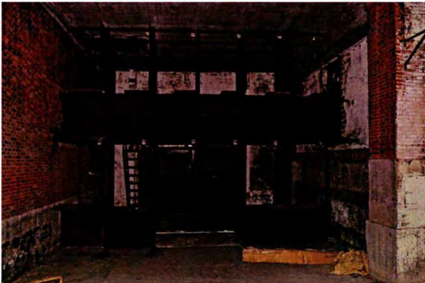
438. Ruimte 093B. Zicht op de restanten van de schietgalerij aan de westzijde van het vertrek. Dit is een door de brand (1991) zwaar aangetaste opstelling in twee lagen voor de schutters. Op de achtergrond is de doorgang te zien naar ruimte 093A. Rechts van de schietgalerij is de nooduitgang te zien. Links van de galerij, in het plafond, hangt de klimtrap naar de bovengelegen rondgang (ruimte 162).
