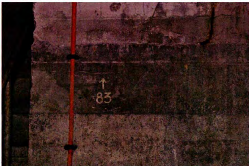
657. Ruimte 202. Detail van de vorige afbeelding links. Op het beton een geschilderde pijl met het getal 83. Of dit tijdens WOII is aangebracht of erna is niet bekend.
