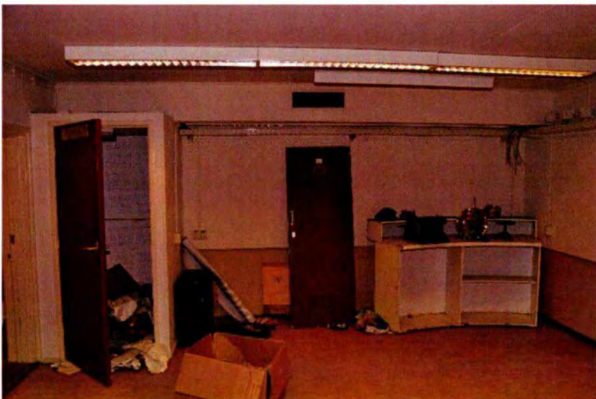
517. Ruimte 139. De zuidwand met aan de bovenzijde een luchtverversingskanaal van de KO. Links de inbouwkast, eveneens uit de KO-periode (circa 1964). De wanden zijn aan de bovenzijde afgewerkt met zachtboardplaten en hebben een lichtbruin geschilderde lambrisering. In deze ruimte is een kaartenrails aanwezig, wat het KO-gebruik van deze ruimte toont als een van de commandoruimtes voor de Oorlogsstaf BLS (zie ook ruimten 140 en 141).
