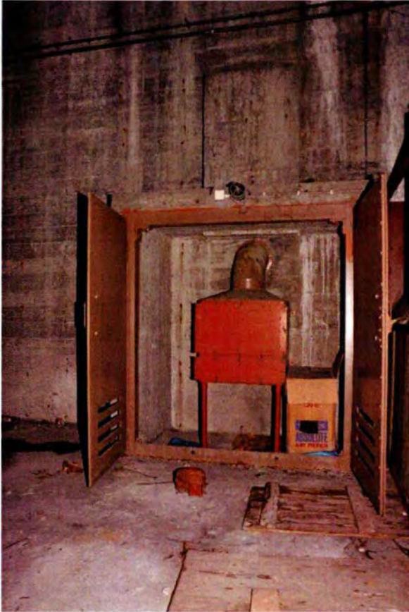
640. Ruimte 99B met geopende deuren. De verse lucht werd via de onderzijde naar het fijnstoffilter (het middelste deel van de kast) geleid, waarna het via de leiding aan de bovenzijde de bunker binnenging richting ruimte 020, waar het in verbinding staat met de installaties voor verse lucht tijdens oorlogstijd.
