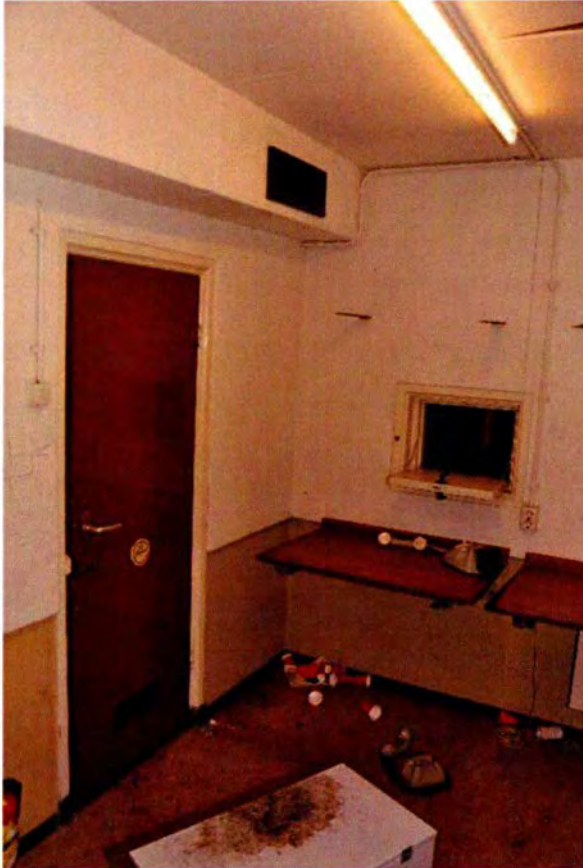
503. Ruimte 136, gezien in zuidwestelijke richting, met tegen de westwand twee opklapbare werkbladen en een doorgeefluik voor berichten. Links de toegangsdeur met erboven een kanaal van de klimaatinstallatie.
