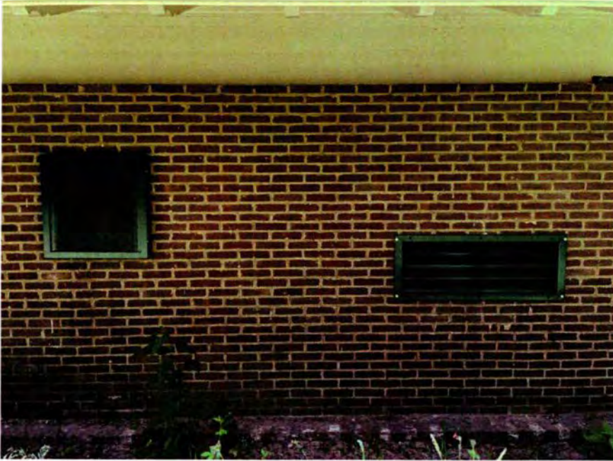
46. In het metselwerk tussen de kolommen van de noordgevel zijn bij de bouw van de schietbaan enkele ventilatieroosters opgenomen. De bouw van de muur is onderdeel van het dichtmaken van de galerij in 1969.
