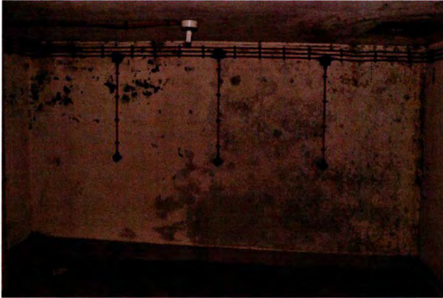
698. Ruimte 91. Overzicht van de noordwand, met elektriciteitsleidingen en drie stopcontacten (1948). Geheel rechts op de foto is een opening in de zoldering zichtbaar. Dit is de toegang tot de lucht-invoerruimte die zich aan de oostzijde van de bovenliggende ruimte bevindt. Dit afvoerkanaal heeft nog een toegang onder de nok en twee ventilatieroosters op de toren. De opzet behoort tot de oorspronkelijke opzet van het gebouw.
