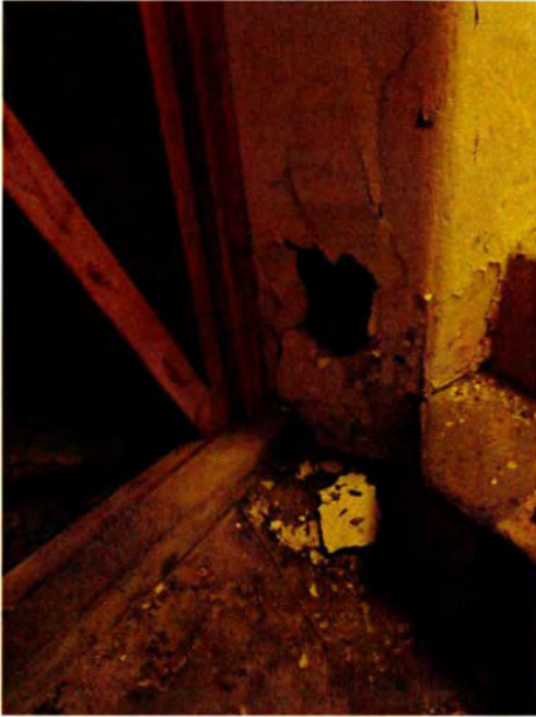
76. Ruimte 001/001B. Detail van losgeraakt stucwerk ter hoogte van de trap.
