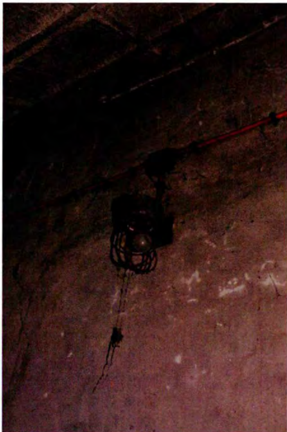
712. Ruimte 93. Detail van een van de lampen in de zolderruimte. Mogelijk dateert deze verlichting nog uit de bouwtijd van de bunker. De oranje bekabeling dateert waarschijnlijk uit 1948.
