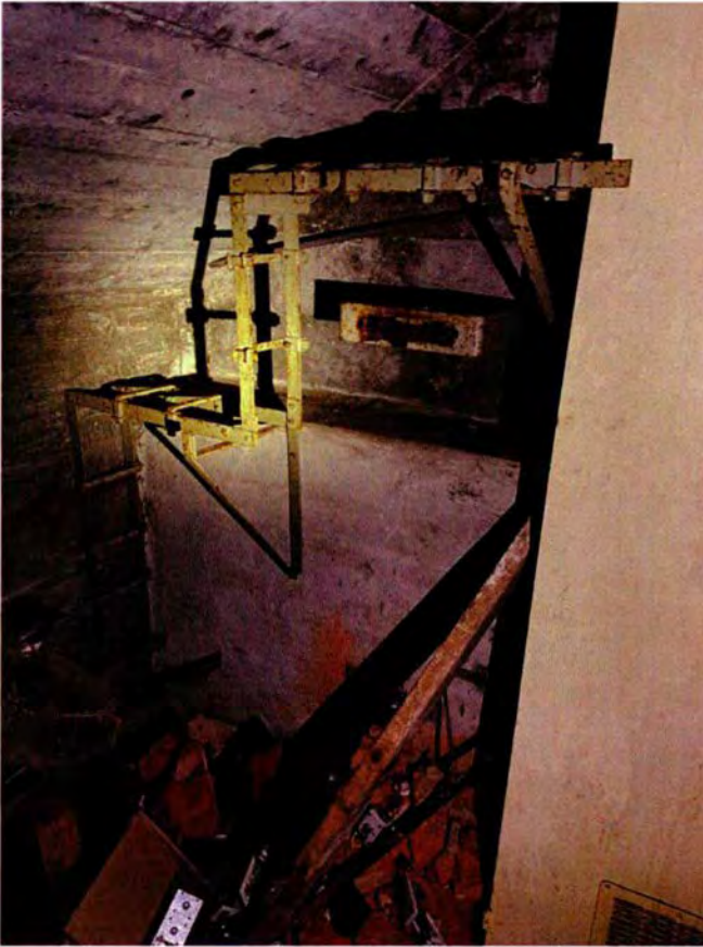
62. De kelderruimte ter hoogte van ruimte 030 in noordelijke richting. Er ligt hier veel rommel, waaronder oude bakstenen en twee deuren. Ook is een oude kabelgoot (1963) zichtbaar die niet meer wordt gebruikt.
