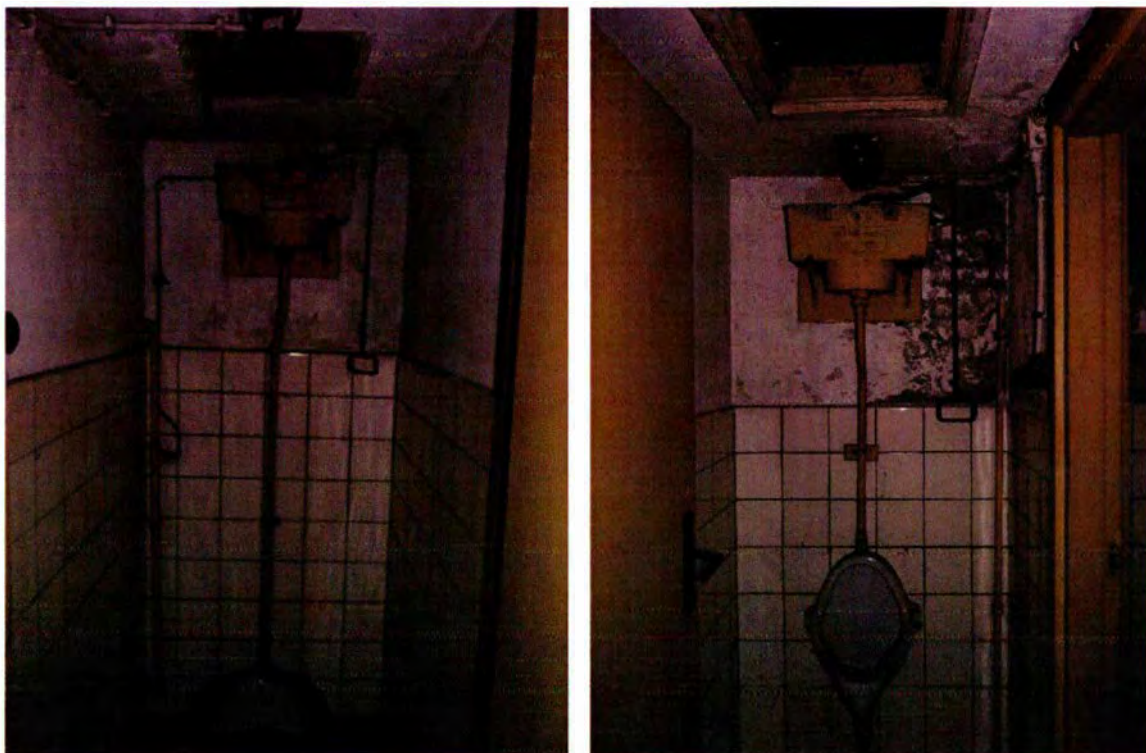
695. Ruimten 89 en 89A. Links de toiletruimte en rechts de voorruimte met het urinoir. Het rooster in het plafond, waar voorheen een rooster zat, gaat naar een bovengelegen uitlaat van de luchtschachten vanuit ruimte 020A.
