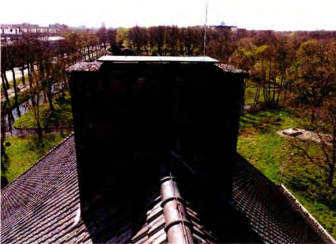
735. De oostzijde van de schoorsteen, waar de drie rookgasafvoerkanalen in uit komen. De schoorsteen is in Vlaams verband opgetrokken en afgedekt met een gewapend betonnen plaat.
