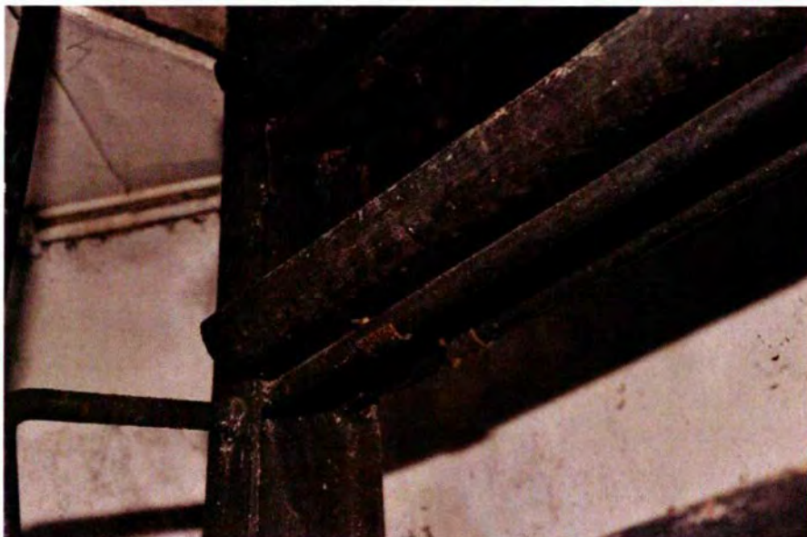
719. Ruimte 402. Detail van de trap, waarop de bevestiging met een beugel aan de onderzijde van de treden goed zichtbaar is. De gehele hier zichtbare constructie dateert nog uit de bouwtijd.
