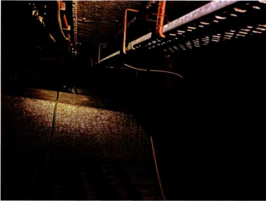
57. De kelderruimte ter hoogte van ruimte 020A, gezien in westelijke richting. Op de voorgrond ligt een kanaal voor de luchtuitlaat. De blauwe kabels in de kabelgoot daaronder gaan op de achtergrond door een muur naar de kelderruimte van afbeelding 54.
