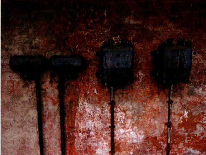
15. Detail van de ijzeren elektrakasten aan de zuidwand van de bunker. Deze elektrakasten dateren van de KO.
