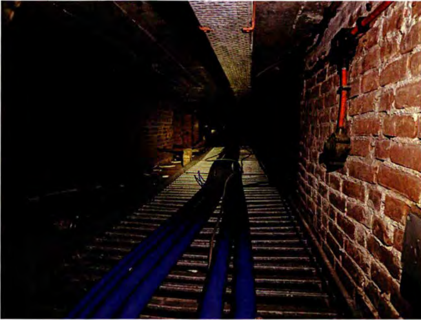
59. De kelderruimte ter hoogte van ruimte 020A in oostelijke richting. Hier is goed te zien dat er veel rommel in de kelder ligt. Op de voorgrond de kabelgoot voor de kabels die de bunker aan de westzijde verlaten. Op de achtergrond, ter hoogte van de daar zichtbare muurtjes, zit een aanzuigventilator die vieze lucht vanuit de ruimtes van de begane grond en eerste verdieping in de kelderruimte aanzuigt.
