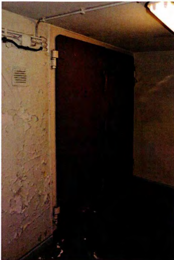
95. Ruimte 002 naar het noordwesten, met de dubbele stalen gasdeur uit de bouwtijd, die toegang geeft tot het inwendige van de bunker (ruimte 005). Ook bij deze deuren heeft men de in het midden geplaatste ijzeren stijl verwijderd. De ijzeren stijl is in de bunker bewaard, in de ruimtes 011 en 020.
