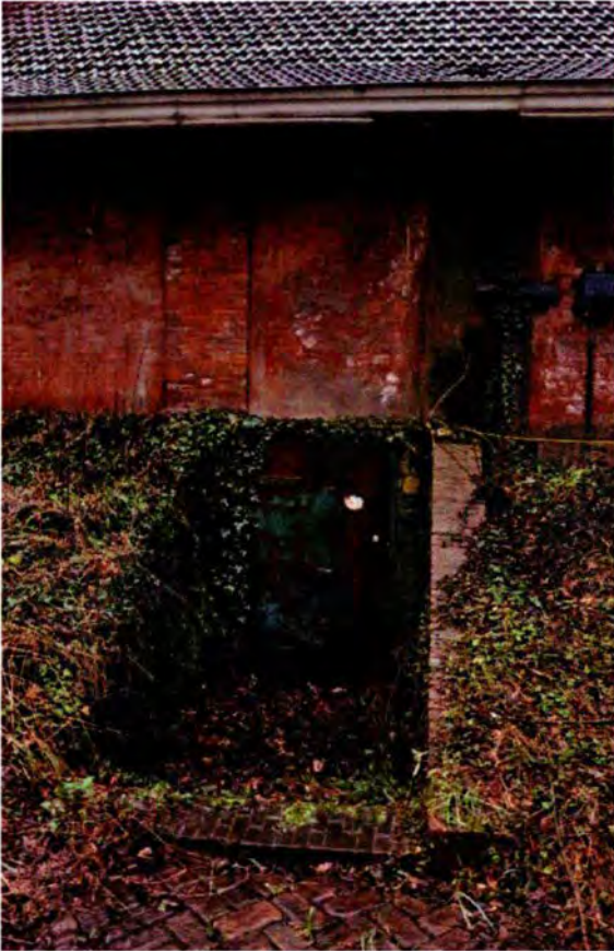
25. De westelijke toegang tot de technische ruimten onder het grote bunkerdak. De beide keermuren zijn na WOII aangebracht. Oorspronkelijk sloot een loopgraaf aan op de toegang. Deze is te herkennen op luchtfoto's uit die periode. De locatie van de toegang behoort tot de oorspronkelijke opzet van de bunker.
