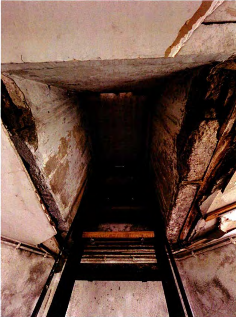
718. Bovenaanzicht van de trap. De bovenste trede, die hier ondersteboven ligt, is smaller dan de overige treden. Het bovenste deel van de trapconstructie met nog een smalle trede is verwijderd. De oorspronkelijke opzet van de trap is zichtbaar op een volgende afbeelding.
