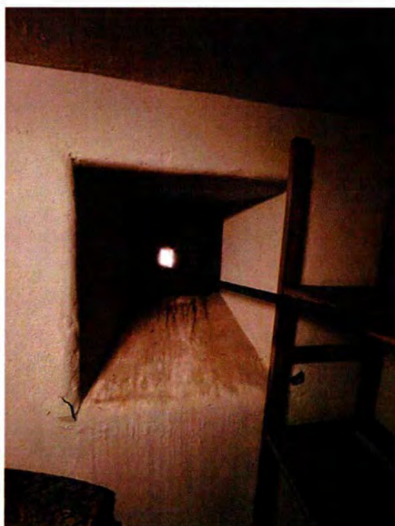
79. Ruimte 001B. Detail van het schietgat, met de pantserplaat van het type 48P8. De schietopening is niet voorzien van een gummidichting (rubberen afdichting) tegen een gasaanval, omdat de ruimte zich nog vóór de gassluis bevindt. Dit in tegenstelling tot de dubbele keukenbunker, waar de ruimte voor de ingangsverdediging toegankelijk is vanachter de gassluis. Deze laatste opzet is gebruikelijk voor Duitse bunkers. Dat de ingang hier voor de gassluis ligt, duidt erop dat de ingangsverdediging in een latere (uitvoerings)fase is toegevoegd, toen het niet meer mogelijk was om de ruimte vanuit de bunker zelf te ontsluiten.
