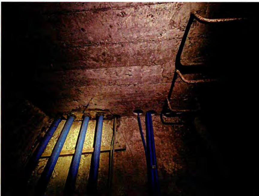
54. Aan de westzijde van de kelder, toegankelijk vanuit ruimte 008, liggen verbindingskabels die de bunker aan de westzijde verlaten en onder de vloer van de westelijke garage zijn gelegd. Vanuit hier loopt ook een rioolbuis die de bunker aan de zuidzijde verlaat. De kelderruimte aan deze oostzijde is grotendeels met muurtjes afgesloten van de rest van de kelderruimte.
