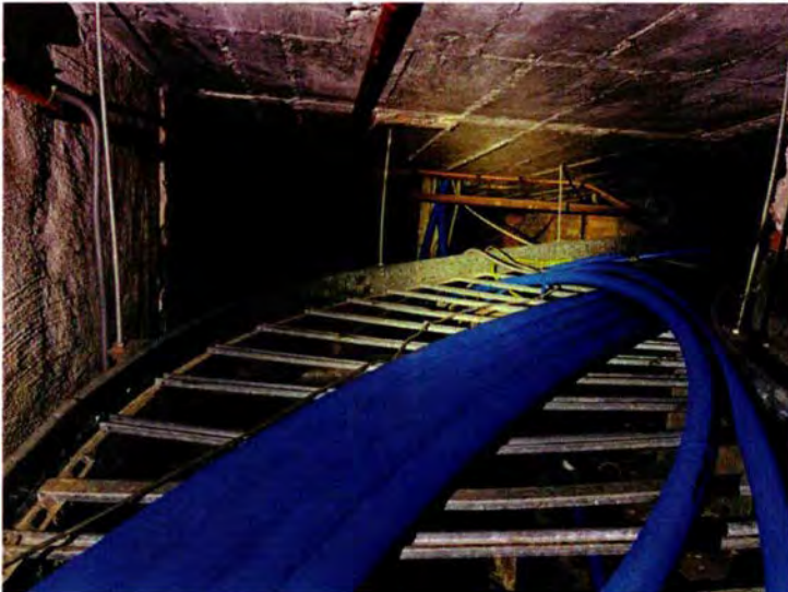
63. De kelderruimte ter hoogte van ruimte 030 in westelijke richting. Deze gebogen kabelgoot komt uit bij de kabelgoot op afbeelding 59. Dit is een nieuw type kabelgoot uit de jaren negentig.
