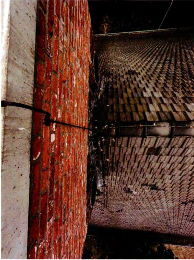
728. Kijkend over de oostelijke rand van de oostelijke observatietoren. Hier zijn, naast de twee ronde luchtroosters, de afwateringstuitjes te zien. De kabel die over het dak naar het platform loopt is een bliksemafleider.
