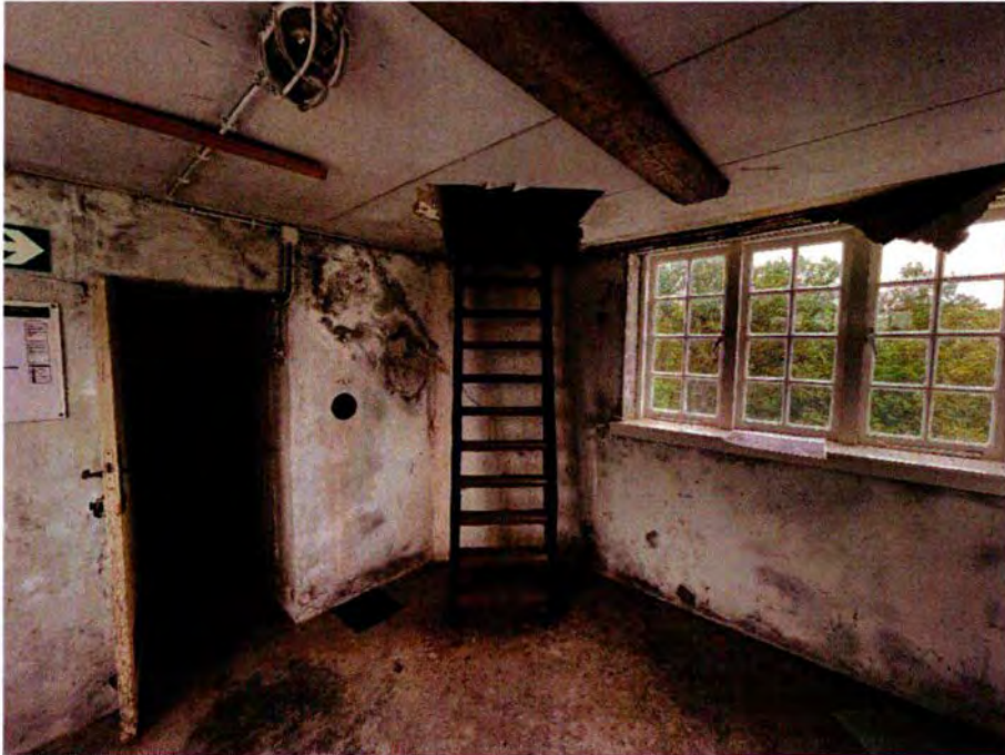
724. Ruimte 402. Overzicht van het westelijke deel met de toegang, in het op de foto de trap naar het observatieplatform en rechts het vervangen venster. De ladder behoort nog tot de oorspronkelijke opzet, alleen de houten treden zijn vervangen.
