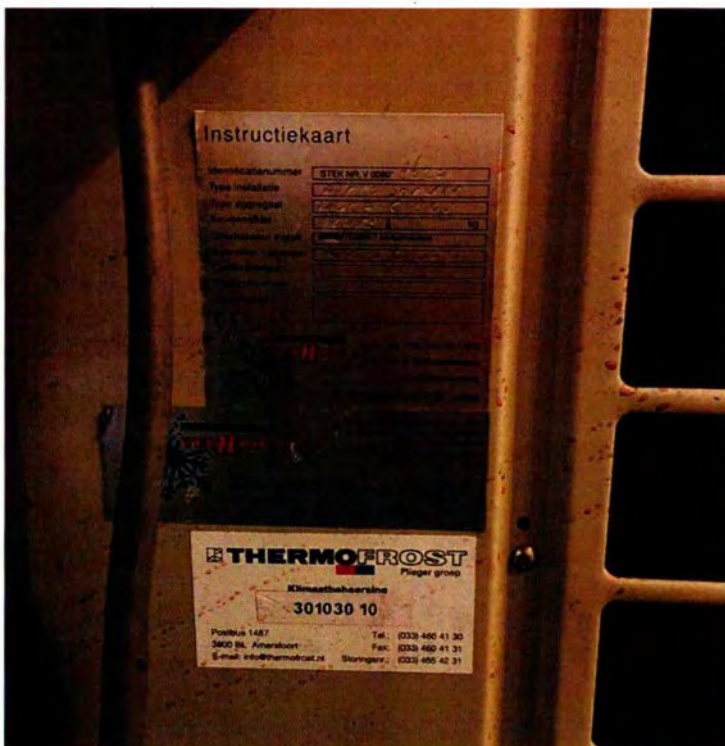
241. Ruimte 028, oostzijde, buiten de kooi van Faraday, gezien naar het westen. Het koelsysteem bevindt zich aan de oostzijde van de kooi van Faraday. In beeld de instructiekaart van het koelsysteem, met een controlesticker uit 2007.
