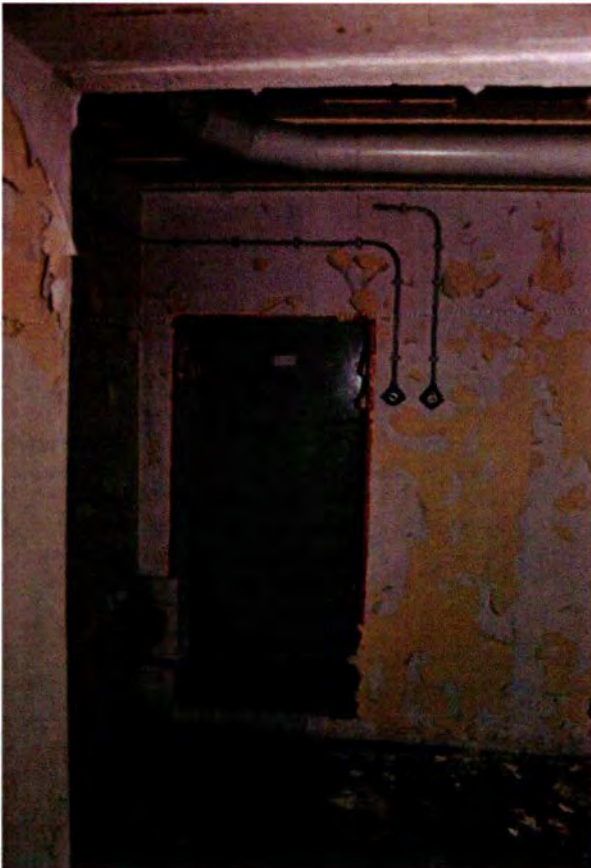
318. Ruimte 105. Het zuidelijke deel van de westwand met de gasdeur (type 19P7) naar de gasluis (ruimte 104).
