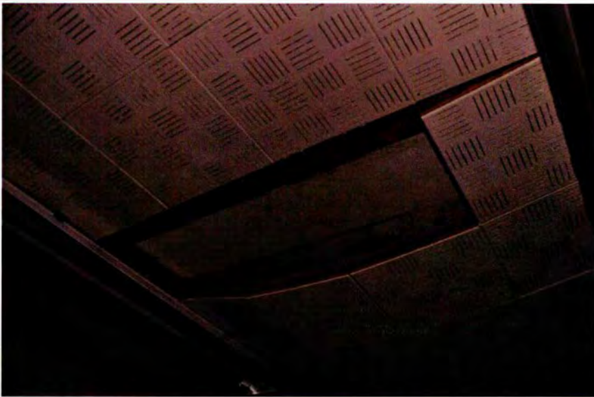
209. Ruimte 022. Detail van een beschadiging van het plafond. Zichtbaar is de bevestiging van het zachtboard op latten tegen de zoldering.
