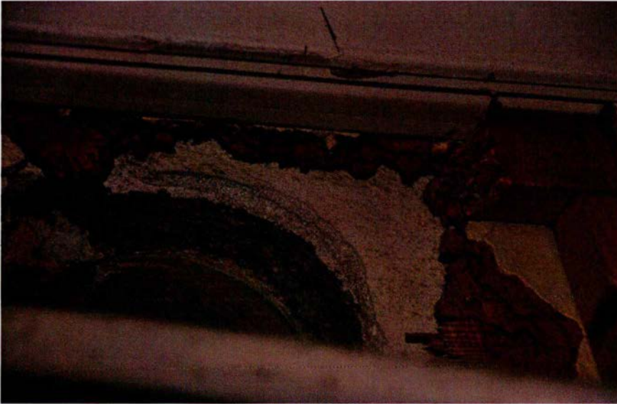
231. Ruimte 028. Detail van de doorbraak op de vorige afbeelding. Op de muur van porisostenen is eerst een raap- of pleisterlaag aangebracht alvorens de houtwolcementplaten aan te brengen. Die platen zijn vervolgens gepleisterd. Het beschadigde zachtboard dat hier na WOII op is bevestigd, is goed herkenbaar, evenals de latere regels met beplating.
