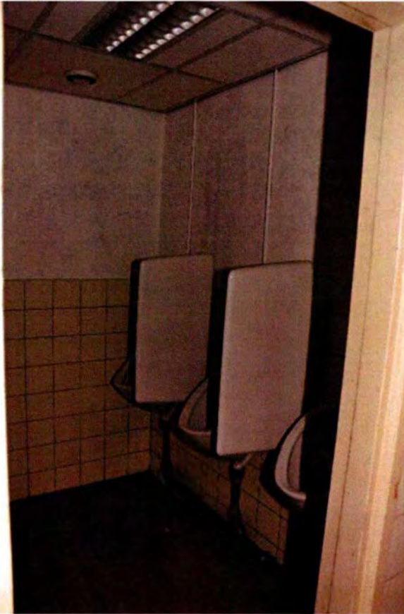
134. Ruimte 011. De ruimte ten oosten van de wasruimte. De drie urinoirs tegen de zuidoever zijn in 1988 geplaatst. Het tegelwerk is ook van de KO (1948). Hier is ook nog een klein deel zichtbaar van het systeemplafond, dat vermoedelijk ook uit 1988 dateert.
