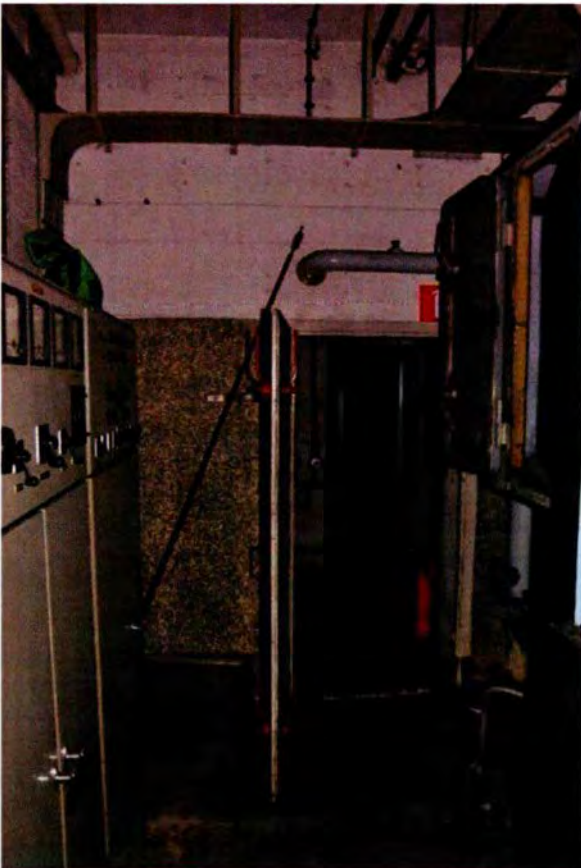
175. Ruimte 020. Het meest westelijke deel van de machinekamer met de deur naar ruimte 018, waar in eerste instantie de waterpomp was opgesteld. De deur dateert uit de bouwtijd en is gasdicht uitgevoerd. Op deze deur staat nog de Duitse tekst 'Maschinenraum'.
