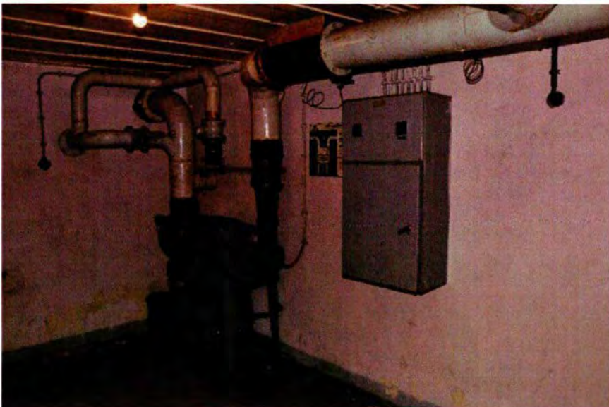
350. Ruimte 111. De zuidwesthoek van het vertrek met de luchtverversingsinstallatie uit de KO (1959). De installatie is uitgevoerd volgens de ontwerptekening uit 1958. Daarbij heeft men gebruik gemaakt van het oude buizenstelsel van WOII voor de verspreiding van de gezuiverde lucht. Fabrikant van de installatie is Piller. Het roestige gedeelte van de buis boven in beeld bevat het verwarmingselement voor het luchtbehandelingssysteem, wat aangeeft dat deze buis diende voor de toevoer van verse lucht voor het zuidelijke gedeelte van de keukenbunker.
