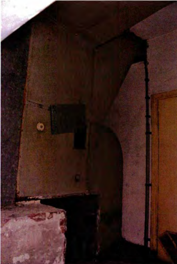
186. Ruimte 020A, het noordwestelijke deel. Rechts is nog net een klein deel van de toegangsdeur te zien. Het kozijn is uit de bouwtijd, de dubbele deuren horen bij de aanpassingen van 1948. Links is een deel van het luchtbehandelingssysteem zichtbaar.
