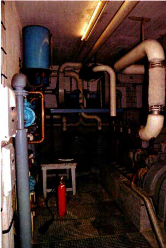
171. Ruimte 020. Het noordelijke deel van de machinekamer met zicht op de koolfilters die uit 1965 dateren. Deze zullen geplaatst zijn als gevolg van de internationale dreigingen tijdens en na de Cubacrisis (1962).
