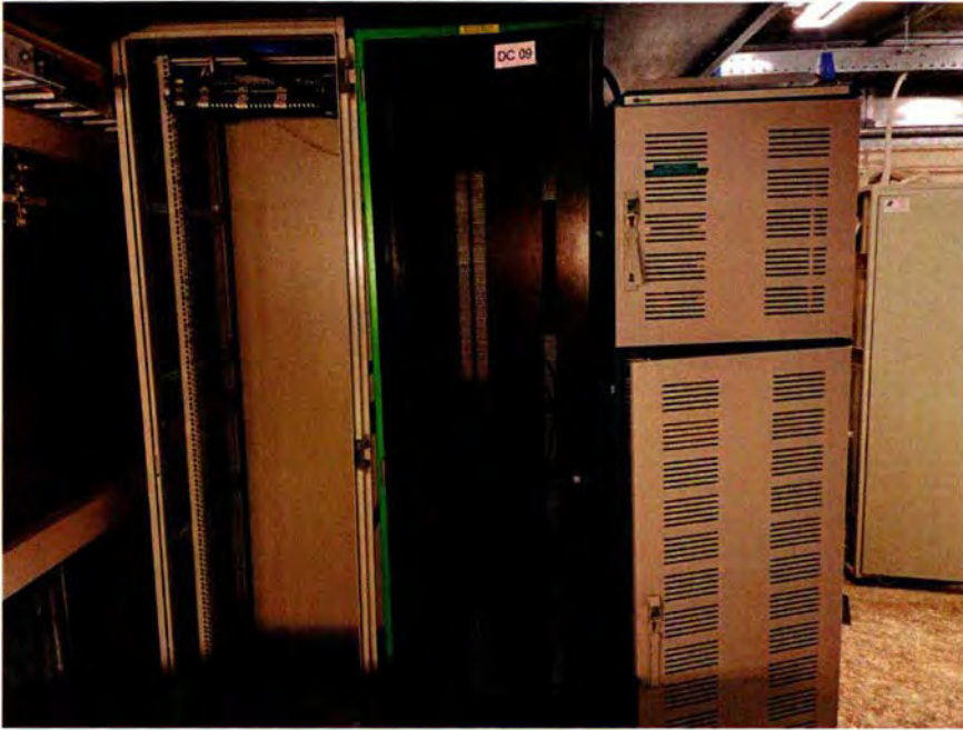
237. Ruimte 028, in noordelijke richting. Links is de westelijke wand van de kooi van Faraday zichtbaar. De serverkasten zijn thans leeg.
