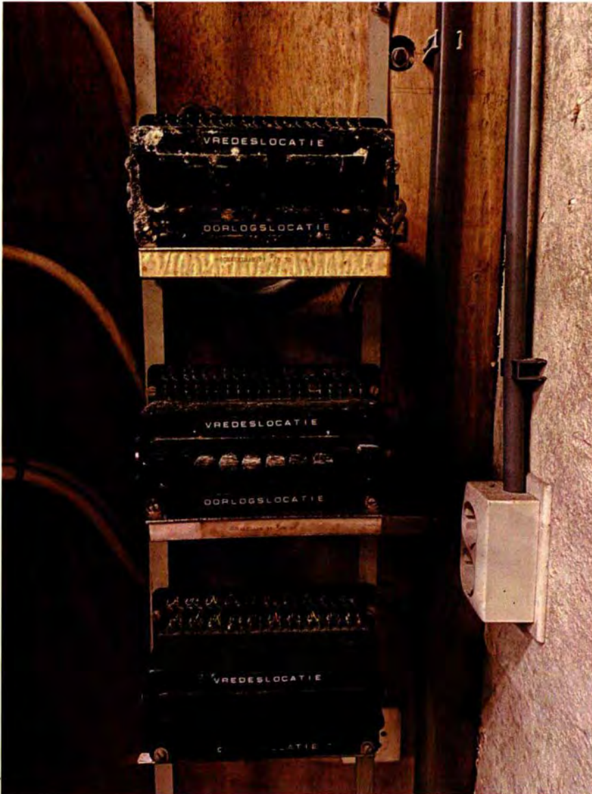
251. Ruimte 030B, zicht op de westelijke wand direct naast de entree deur. Rechts is de noordwand van ruimte 030B zichtbaar. Verschillende schakelaars konden hier worden omgezet van de functie 'vredeslocatie' naar de functie 'oorlogslocatie'. De functie 'oorlogslocatie' werd waarschijnlijk gebruikt tijdens oefeningen en in een oorlogssituatie. Een uniek interieurstuk.
