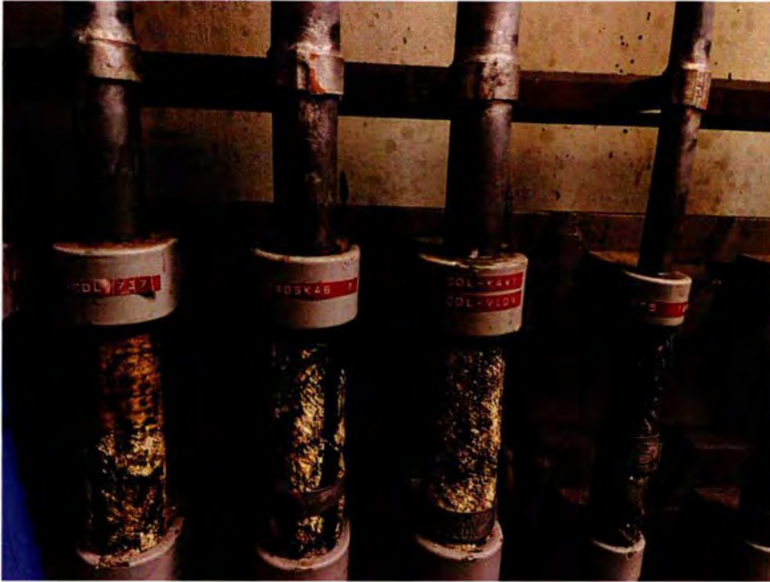
247. Ruimte 030, in zuidelijke richting. Detail van enkele kabelhouders met afkortingen die verwijzen naar de verschillende verbindingen.
