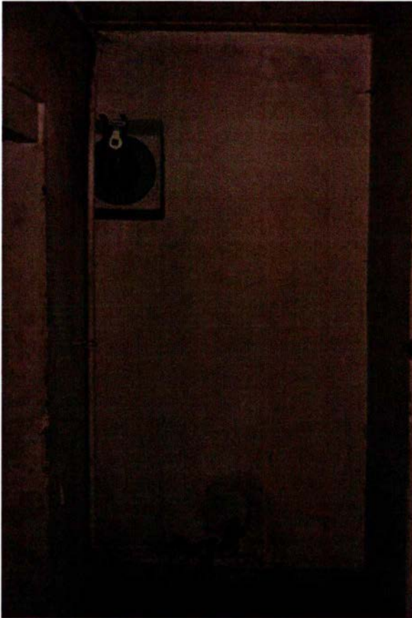
360. Ruimte 113. De zuidwand, met boven in de muur een overdrukventiel.
