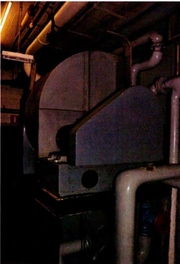
179. Ruimte 020. Detail van de vorige afbeelding met wat vermoedelijk de aandrijfmotor van de luchtbehandeling is. Op de voorgrond is nog net een klein deel van de motor zichtbaar, die dient voor de aandrijving van de luchtbehandeling, de achtergelegen aanzuigventilator.
