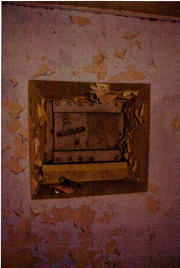
319. Ruimte 105. Het schietgat in de westwand, gericht op de ingang van de bunker. Aan de andere zijde van de muur is het schietgat met een plaat afgedekt. Het ijzeren schietgat is van het type 483P2.
