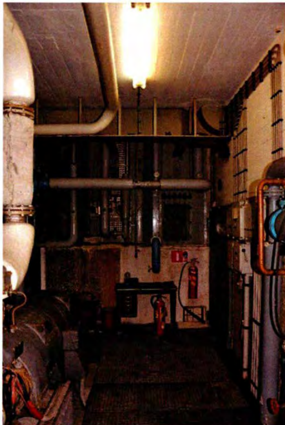
172. Ruimte 020. Het noordelijke deel van de westwand met een deel van de grote luchtkanalen met bijbehorende meet- en regelinstrumenten.
