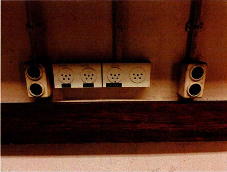
144. Ruimte 014: Stopcontacten en telefoonaansluitingen met codes tegen de zuidwand van de ruimte, zoals deze door heel de bunker zichtbaar zijn. Deze verwijzen naar de functie als verbindingcentrum.
