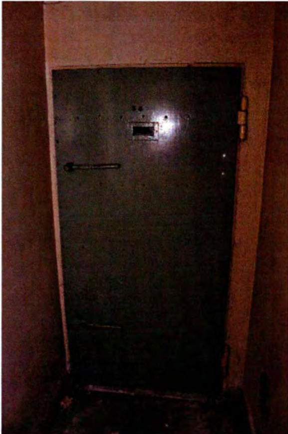
312. Ruimte 104. De oostwand met de gasdeur naar ruimte 105. Rechts onder is nog net de uitlaat van het overdrukventiel zichtbaar, dat de binnenzijde van de bunker met de luchtsluis verbindt.
