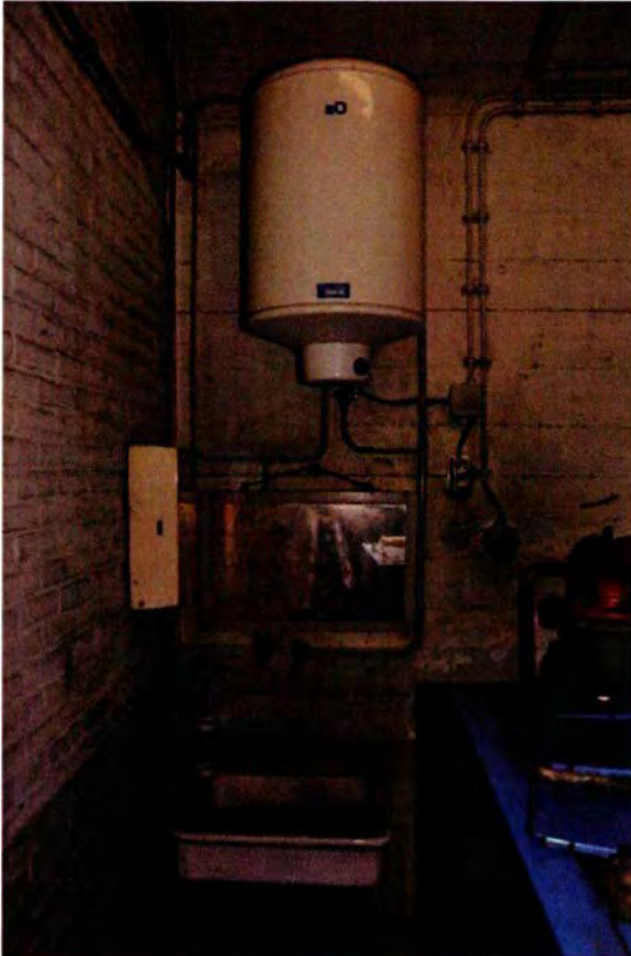
155. Ruimte 017. De moderne boiler tegen de noordwand. Links de witgeschilderde, in schoon metselwerk uitgevoerde, westwand van het vertrek.
