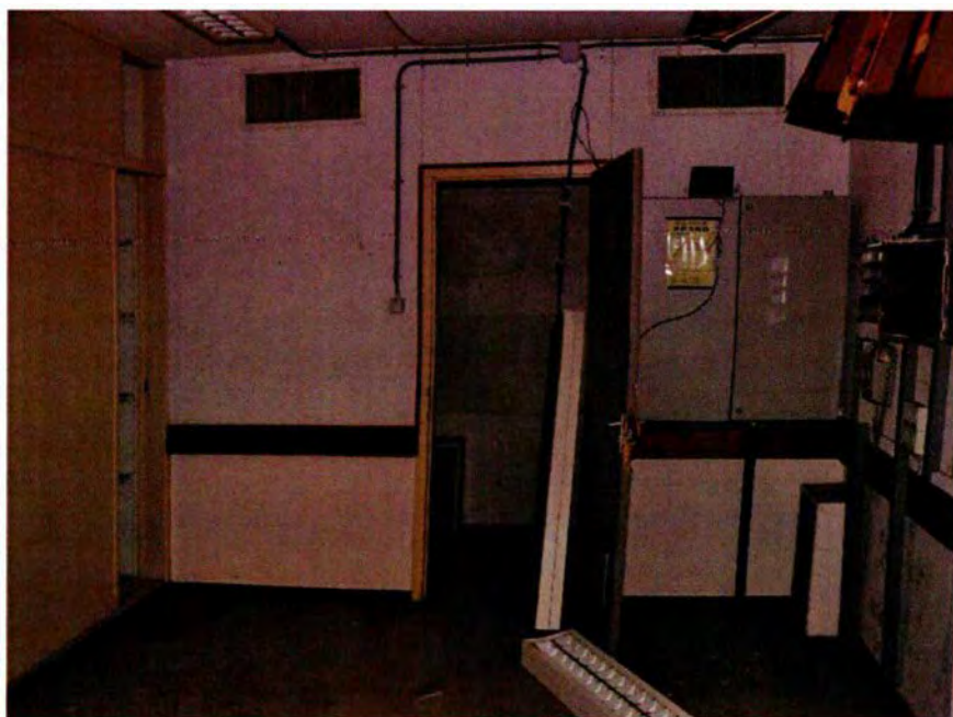
244. Ruimte 029. De zuidwand met de toegangsdeur. In de wand is een tweetal ventilatieroosters van de luchtverversing (toevoer) opgenomen. Rechts naast de deur is een elektrakast (tweede helft 20ste eeuw) tegen de wand bevestigd.
