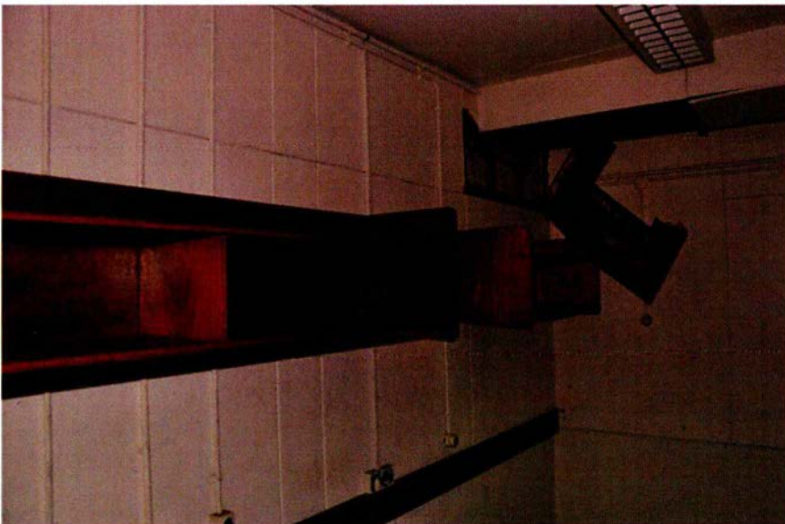
145. Ruimte 014 naar het zuidwesten. Tegen de zuidwand heeft men omstreeks 1964 opbergkastjes geplaatst. Rechtsboven is de bekleding van de luchtbehandelingsinstallatie deels verwijderd. De kanalen zijn in 1964 aangebracht. Links ervan is zichtbaar hoe de kanalen door de betonnen wand, die de begane grond van de bunker in tweeën verdeelt, zijn gehakt.
