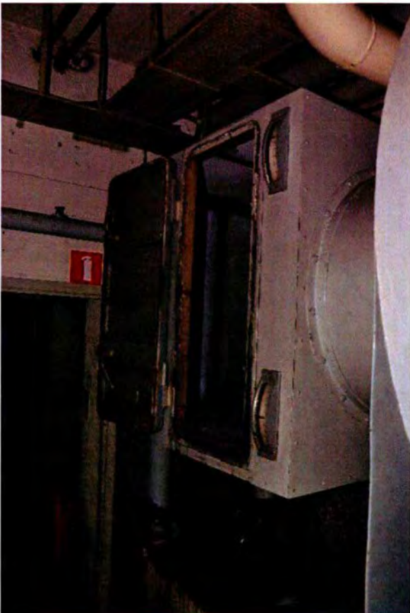
181. Ruimte 020. De kast van de luchtbehandeling met toegang tot de luchtkanalen in geopende toestand.
