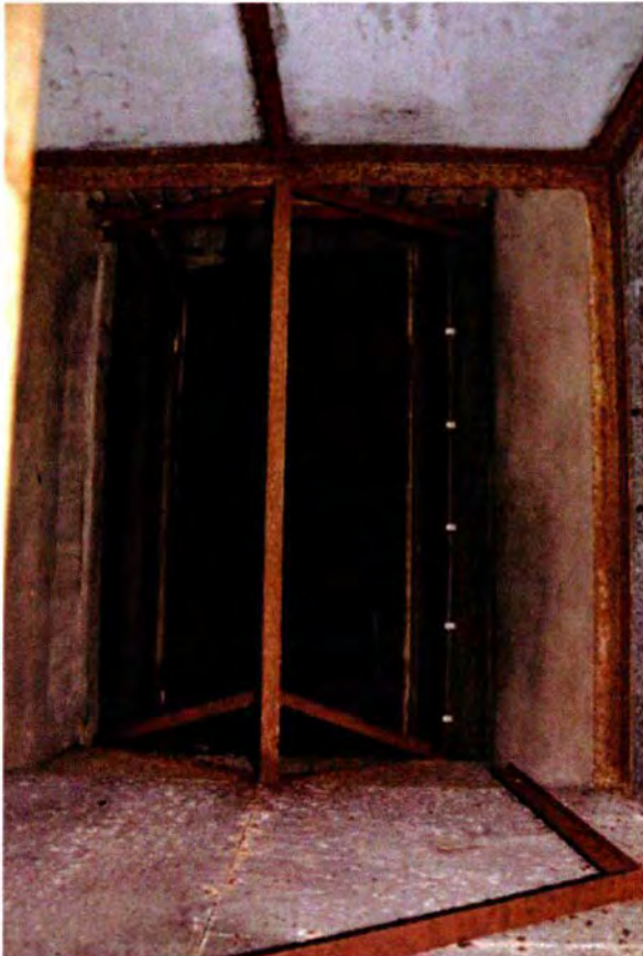
182. Ruimte 020. Het inwendige van het kanaal van de vorige afbeelding. De stalen gasdeuren stammen uit de bouwtijd en bieden toegang tot de luchtschachten, wat in feite ruimte 020A is. Op de voorgrond zijn de panelen zichtbaar waarin filters konden worden geplaatst.
