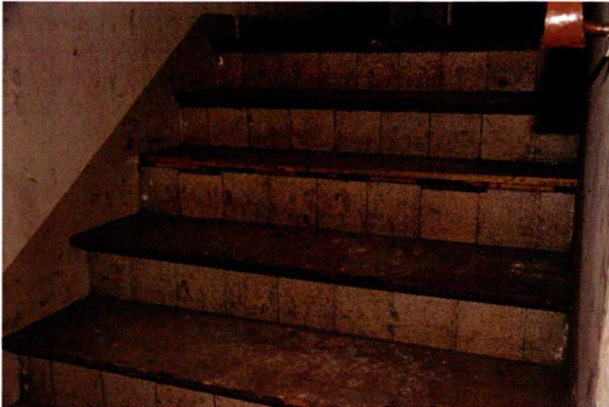
266. Ruimte 031, trappenhuis. Bij de bovenste trapvlucht is het voorste deel van een van de treden verloren gegaan, waardoor de constructie zichtbaar is geworden. De relatief dunne dektreden zijn gesteld op dunne latjes van divers formaat.
