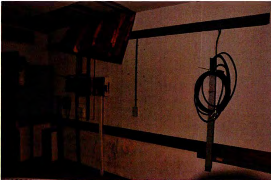
245. Ruimte 029. Overzicht van de westwand, met links voorzieningen voor telefoon en elektra. Een klein deel van het zachtboardplafond is verwijderd, waardoor er zicht is op de oorspronkelijke plafondafwerking.
