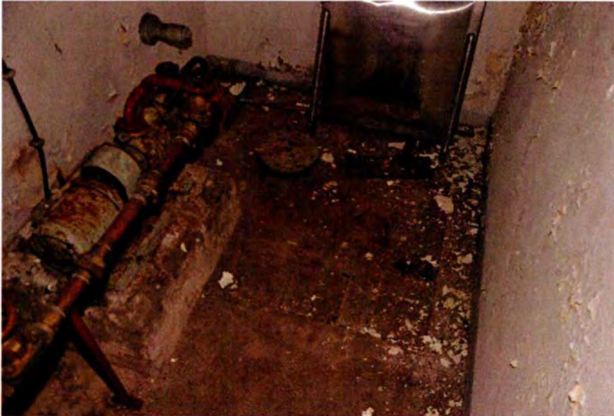
337. Ruimte 108. Het noordelijke deel van de ruimte. Links de op een bakstenen basement geplaatste waterpomp. Met enige moeite is onder dit basement de rand om de rechthoekige waterput zichtbaar.
