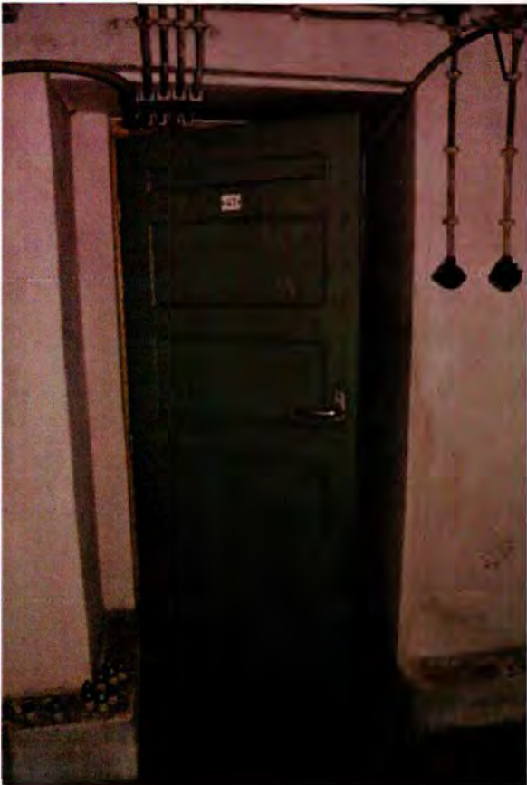
358. Ruimte 112. De houten paneeldeur tussen de vertrekken 110 en 112 dateert uit de bouwtijd van de bunker.
