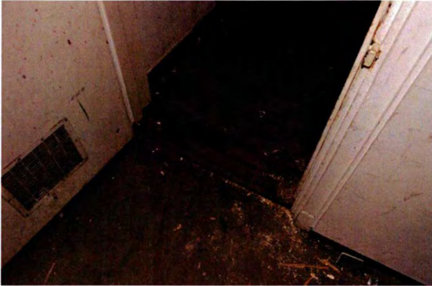
233. Ruimte 028. Detail van de onderdorpel in de deuropening naar de gang (ruimte 031). De onderdorpel (bouwtijd) is van eikenhout en wijkt daarmee af ten opzichte van wat elders in de bunker is toegepast.
