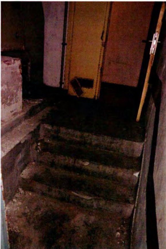
185. Ruimte 020A, gezien in noordelijke richting, in de richting van de toegang. Het vloerniveau is verlaagd ten opzichte van de gang, maar het niveau van de machinekamer ligt nog boven dat van de kelder.
