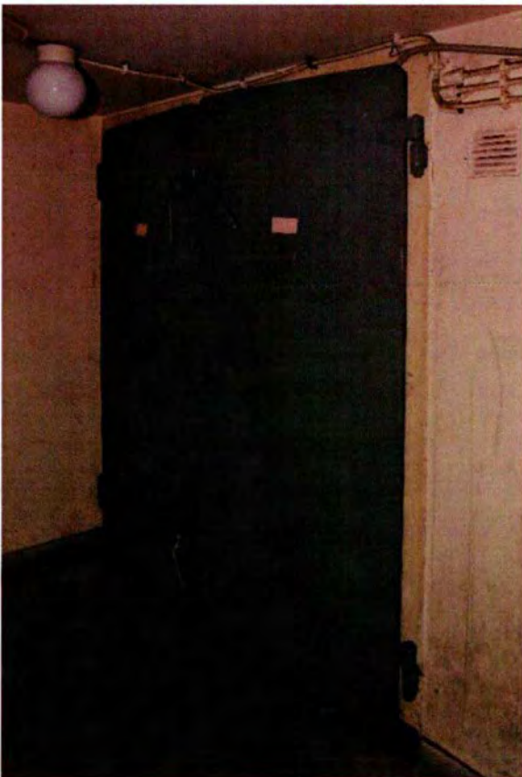
277. Ruimte 033. De buitenzijde van de binnenste dubbele deur van de gassluis. De gehele opzet dateert, met uitzondering van de kleurstelling, uit de bouwtijd. Rechts is de uitlaat van het binnenste overdrukventiel zichtbaar.
