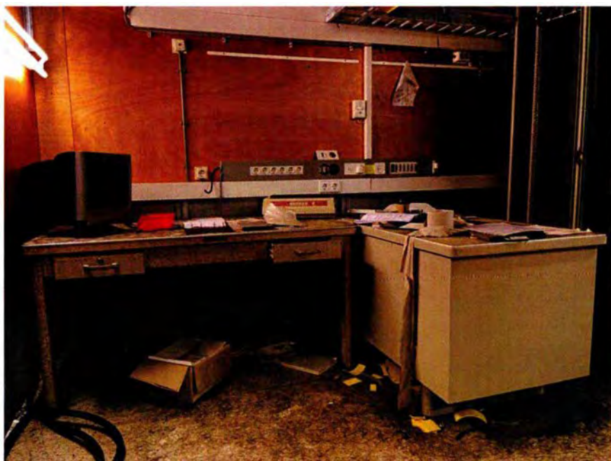
236. Ruimte 028. Het bureau in westelijke richting, in de kooi van Faraday. Aan de rechterkant staan enkele serverkasten die thans leeg zijn.
