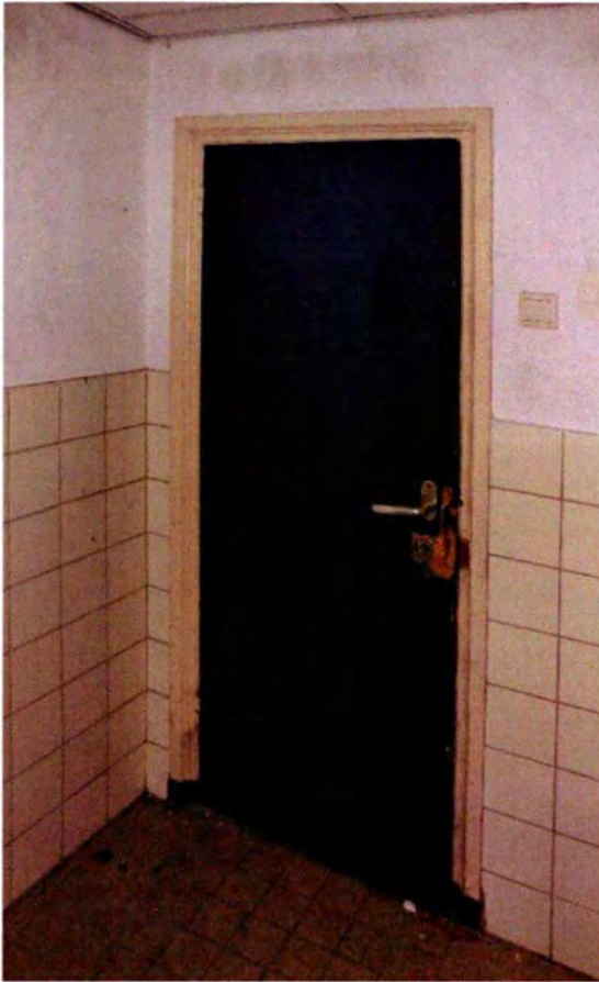
126. Toegangsdeur van ruimte 009. Het kozijn en de omlijsting zijn oorspronkelijk. De deur zal bij het herstel gedurende de KO (1948) zijn geplaatst. Onder in de deur is, net als bij alle deuren die uitkomen op de gang, een ventilatieopening aangebracht.
