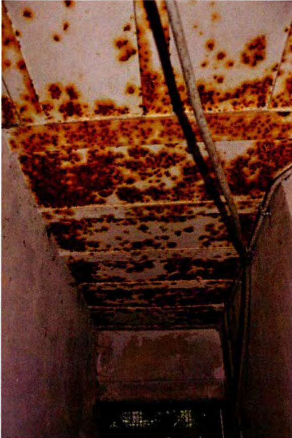
367. Ruimte 114. Het plafond van de toegang. De zoldering bestaat, net als elders in de keukenbunker, uit stalen liggers met ertussen stalen platen. Het geheel diende als verloren bekisting voor het betondak.
