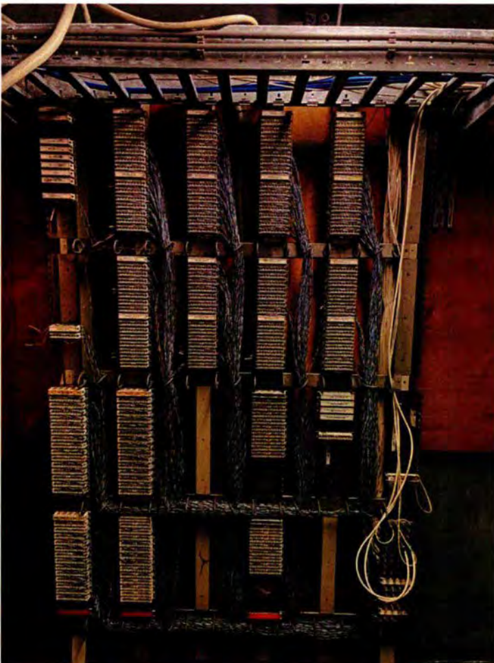
238. Ruimte 028. De zuidwand van de kooi van Faraday met schakelkasten voor telefoon- en telexverbindingen. Bovenin een kabelgoot.
