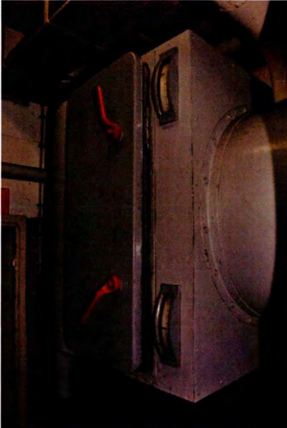
180. Ruimte 020. De kast van de luchtbehandeling, waarmee de kanalen van de luchtbehandeling geïnspecteerd konden worden, in gesloten toestand.
