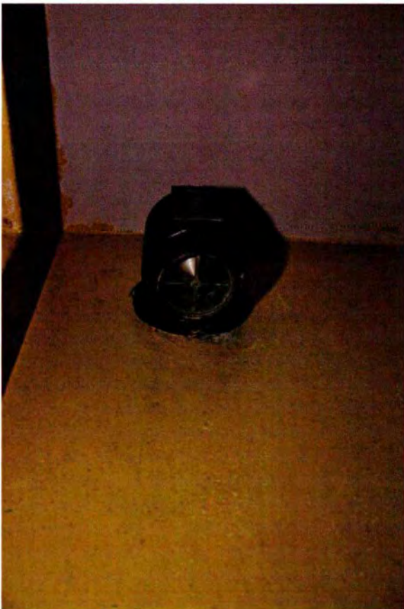
279. Ruimte 033. Het overdrukventiel behorend bij de buitenste gasdeur van onderaf gezien.
