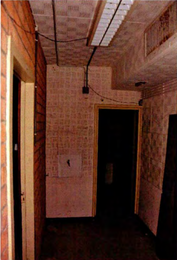
270. Het meest oostelijke deel van gang 031E, gezien in oostelijke richting. Links de zuidwand van ruimte 025 van na 1983 en rechts de gewapend betonnen wand die de bunker in de lengterichting in tweeën verdeelt.
