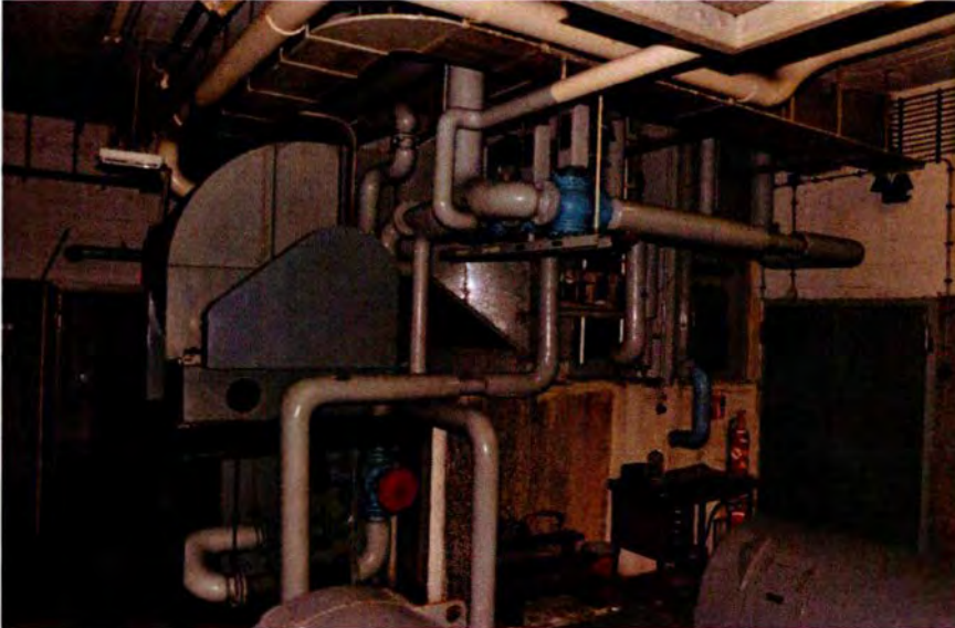
178. Ruimte 020. De westzijde van het vertrek met de luchtbehandelingskanalen die hier forse afmetingen bezitten. In deel I wordt het luchtbehandelingssysteem nader toegelicht, aangezien dit systeem betrekking heeft op meerdere ruimtes door de gehele bunker en het verdient om in een bredere context te worden beschreven.
