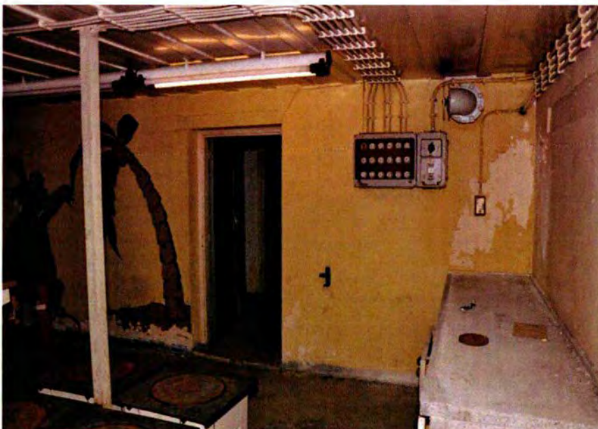
325. Ruimte 107. Het oostelijke deel van de noordwand met de doorgang naar ruimte 106. De stoppenkast dateert uit de KO-periode (1959).
