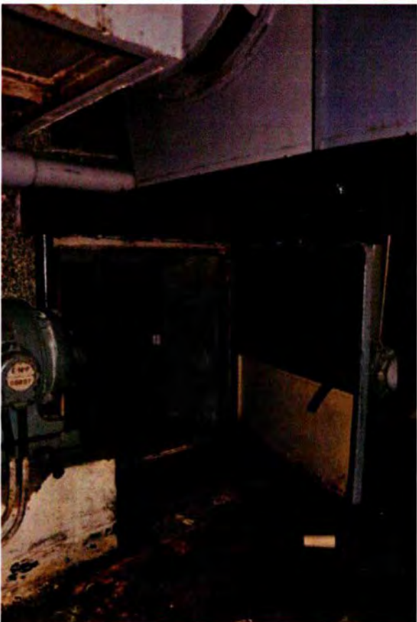
183. Ruimte 020. Onder de luchtverseringsinstallatie in het westelijke deel van ruimte 020 is een luik dat toegang geeft tot de kruipruimte van ruimte 020A. Deze kelderruimte diende voor de luchtuitlaat. Na dit luik naar links geeft de kruipruimte toegang tot de aanzuigventilator voor de luchtuitlaat. Voor zover valt na te gaan behoort de doorgang tot de oorspronkelijke opzet. Het stalen luik zal ten tijde van de KO zijn geplaatst.
