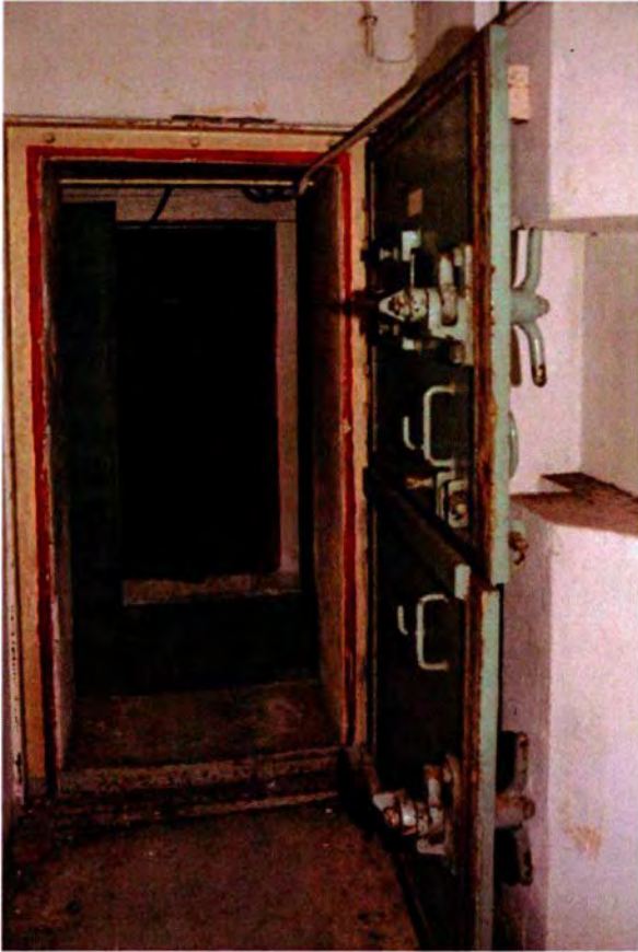
307. Ruimte 103. De geopende pantserdeur. Op de achtergrond een tweede pantserdeur van hetzelfde type, tussen de ruimten 104 en 107. Links is nog net een klein deel van de gasdeur zichtbaar, die de toegang tot de ruimte met de ingangsverdediging (105) afsluit.
