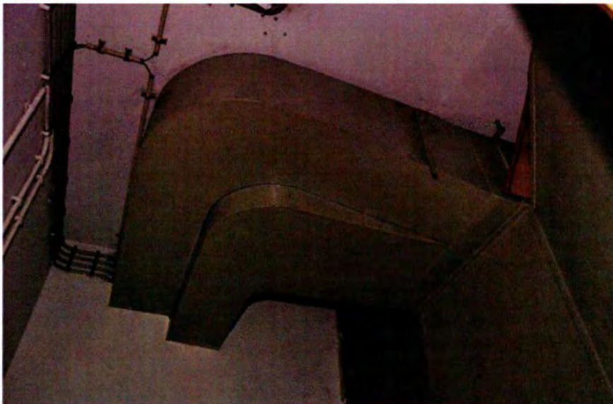
187. Ruimte 020A. Het bovenste deel van de luchtbehandelingskanalen die het grootste deel van de ruimte in beslag nemen.
