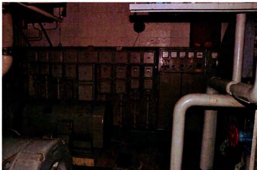
173. Ruimte 020. De zuidwand met de schakelkasten voor de elektra. Ook deze dateren uit de KO-periode (1957).
