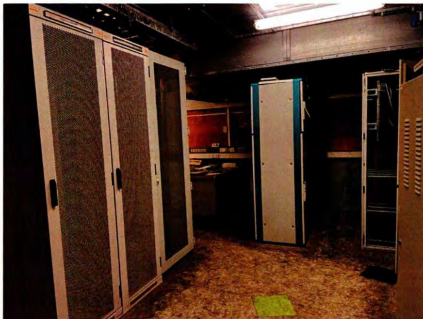
235. Ruimte 028. Inkijkje in de kooi van Faraday in westelijke richting. De kooi staat vol met serverkasten. Links achterin, tegen de zuidwestkant staat een bureau voor de onderhoudsmonteur, de enige persoon die de kooi van Faraday en ruimte 028 betrad.
